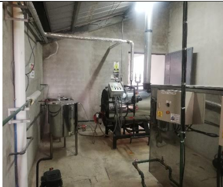
CUARTO DE MÁQUINAS Caldero horizontal 10 BHP y Banco de Hielo de 2HP
