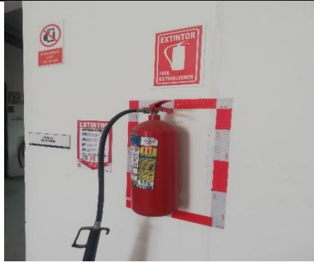
EQUIPO DE EMERGENCIA Extintor de CO 2 de 15 lbs
