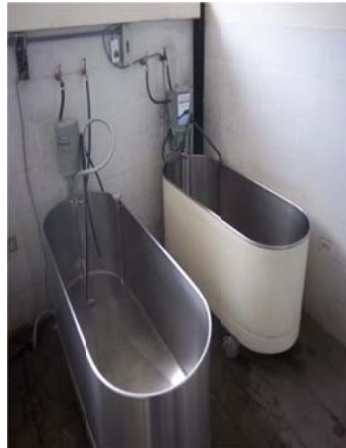
Figura 26 Instalación para la aplicación de Hidroterapia
