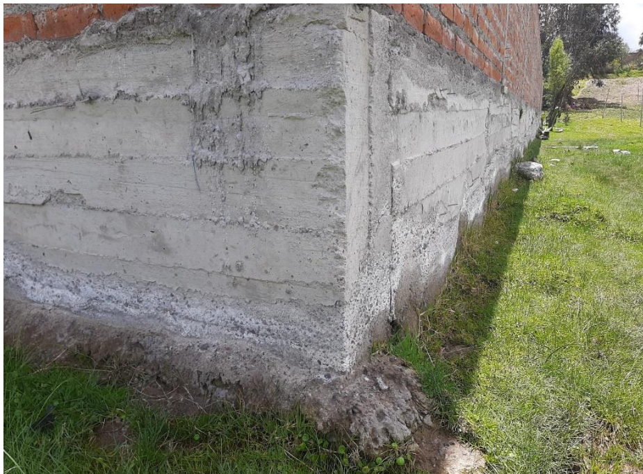
Figura 23 Anexo 5: Eflorescencia en muro de cerramiento (V14, coordenadas WGS84 765532.31 m E, 9818727.39 m S).
