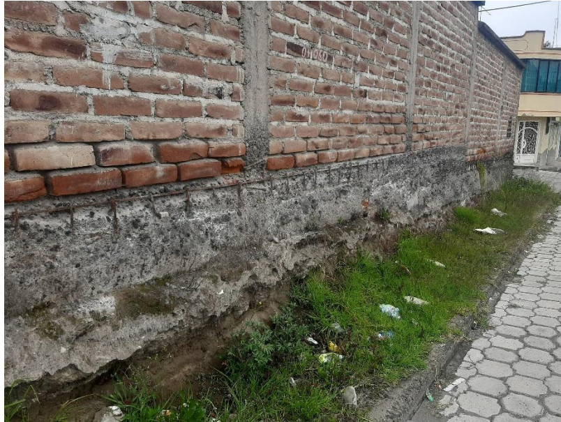
Figura 28 Anexo 8: Desprendimiento del hormigón de recubrimiento de la columna y exposición del acero de refuerzo (V13, coordenadas WGS84 765264.02 m E, 9818667 m S).
