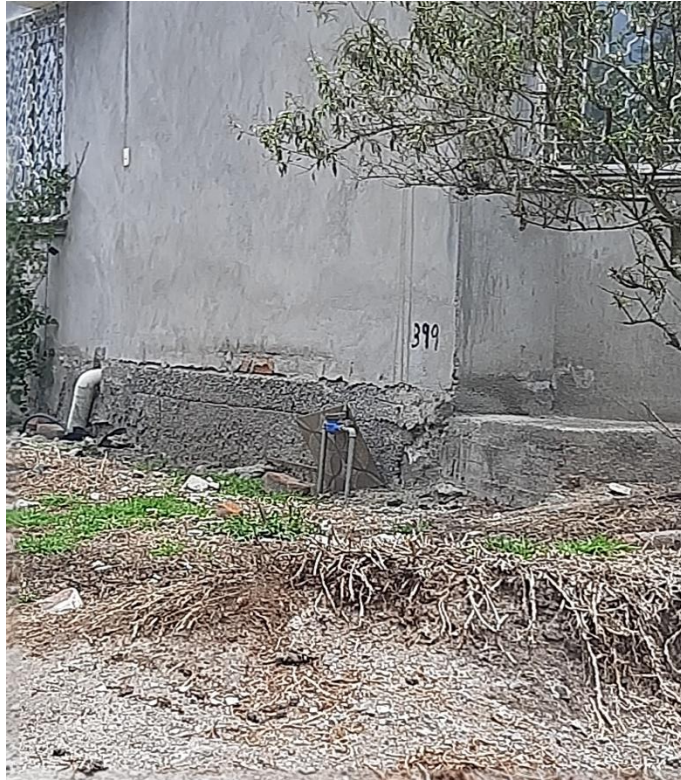
Figura 24 Anexo 5: Desprendimiento del Hormigón (V11, coordenadas WGS84 764902.34 m E, 9818681.69 m S).
