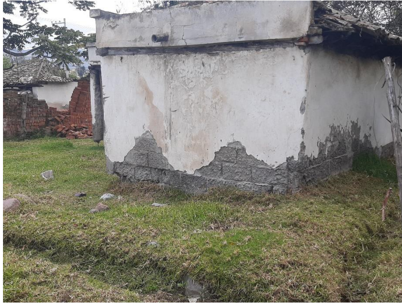
Figura 30 Anexo 9: Disgregación de elementos de hormigón y bloque de mampostería (V19, coordenadas WGS84 765630.02 m E, 9818629.98 m S).
