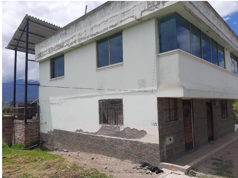
Figura 27 Anexo 8: Vivienda con desprendimientos de hormigón de la facha lateral (V30, coordenadas WGS84 765379.80 m E, 9818762.18 m S).
