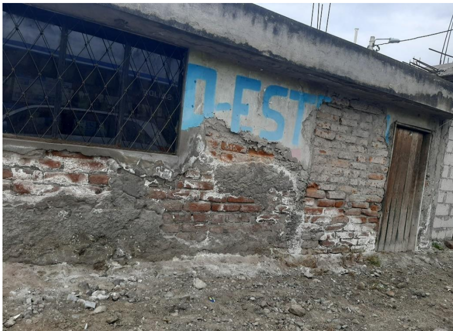
Figura 25 Anexo 6: Desprendimiento de hormigón de la fachada (V12, coordenadas WGS84 765090.01 m E, 9818657.46 m S).
