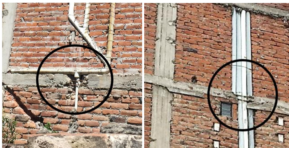
Ilustración 14. Desprendimiento de Concreto, tubería y acero expuesto
