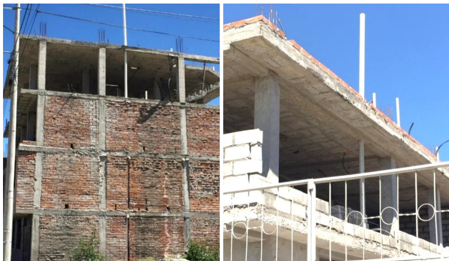
Ilustración 15. Corte de elementos por tuberías en edificios en construcción
