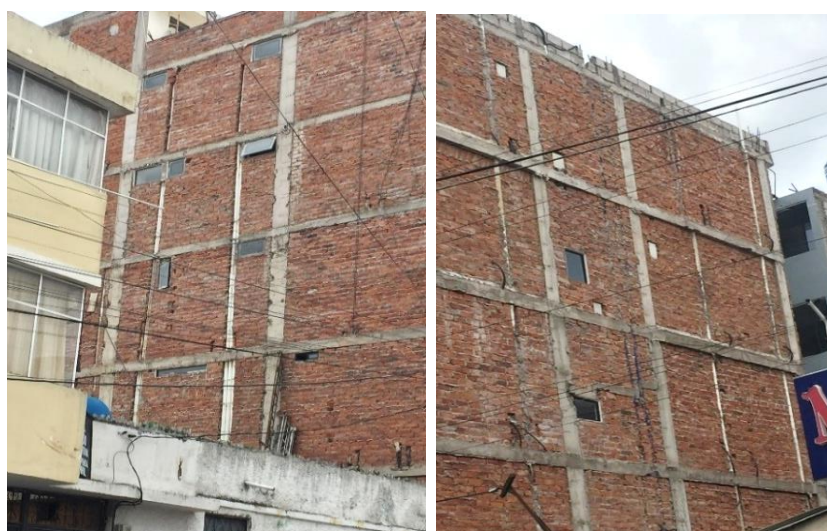
Ilustración 11. Tuberías atravesando Vigas (Edificaciones de 4 o más pisos)
