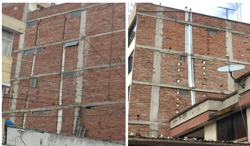
Ilustración 16. Vigas atravesadas por dos o más tuberías en un solo punto
