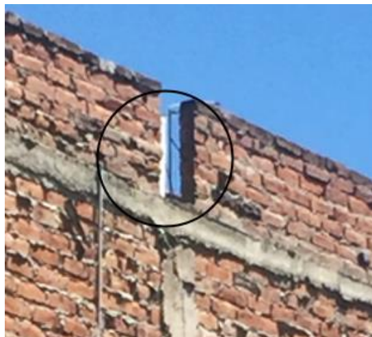
Ilustración 17. Tubería embebida en columna
