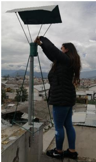
Fotografía 5. Instalación de estaciones de material particulado sedimentable. Fuente: Autor (2021).
