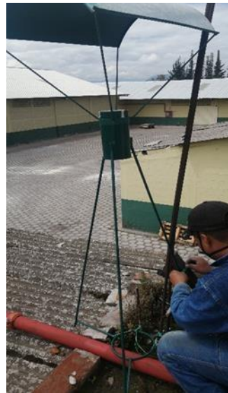
Fotografía 6. Instalación de estaciones de material particulado sedimentable. Fuente: Autor (2021).
