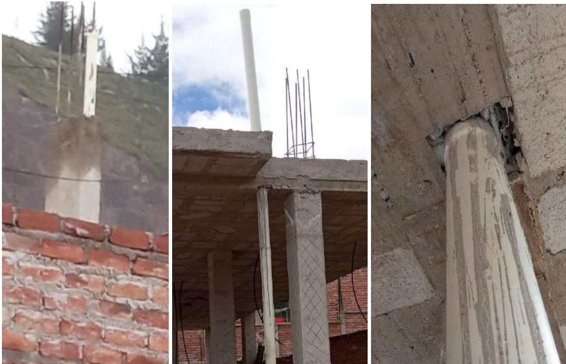
Figura 10.- Embebimiento de tuberías en columnas y cruce de tuberías en vigas Elaborado por: Rivera (2021)
