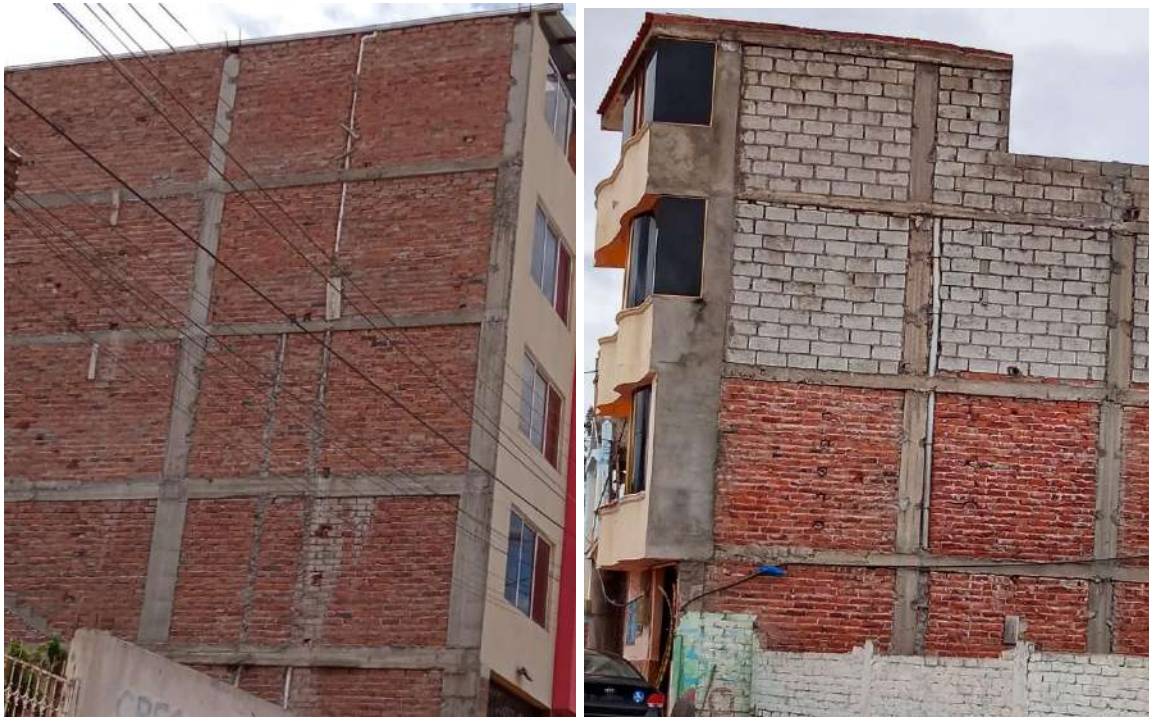
Figura 15.- Edificaciones de 5 y 4 pisos con vigas atravesadas por bajantes situadas en la parroquia “La Matriz” Elaborado por: Rivera (2021)
