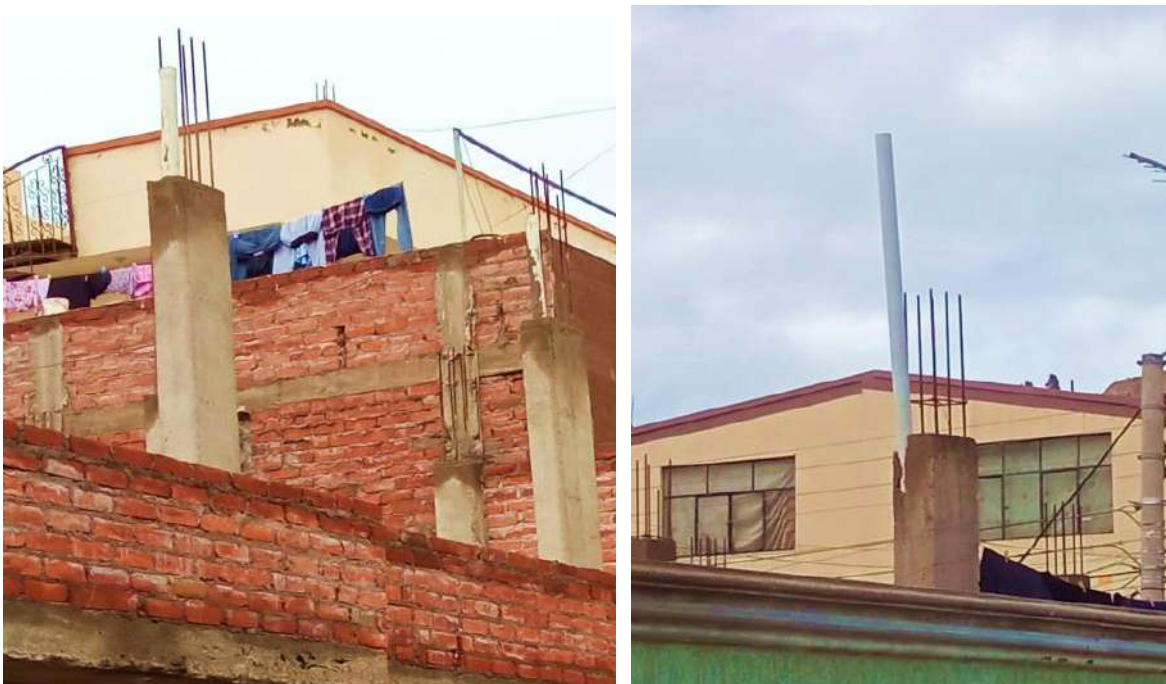
Figura 7.- Tubería embebida en una columna Elaborado por: Rivera (2021)
