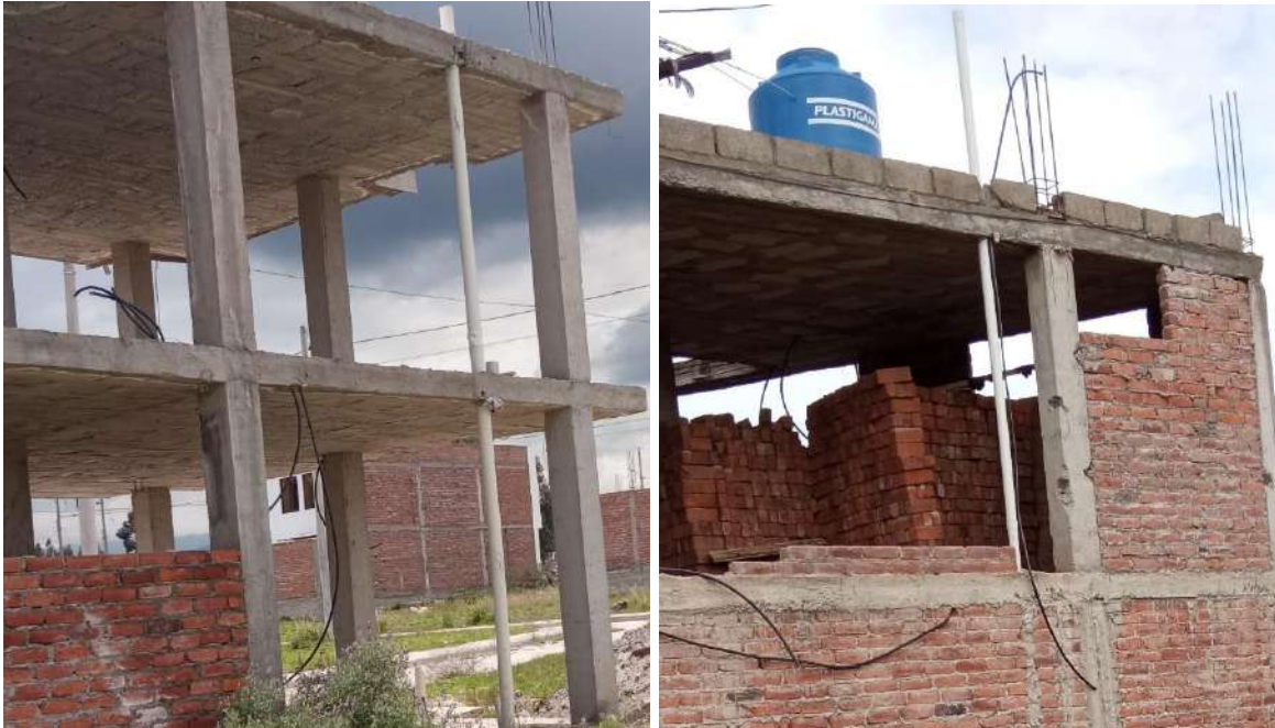
Figura 19.- Tuberías atravesando vigas en edificaciones en construcción Elaborado por: Rivera (2021)
