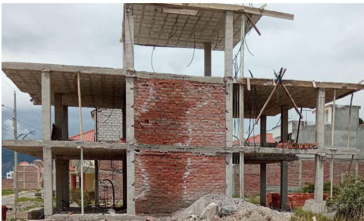
Figura 12.- Construcción con tres bajantes atravesando viga Elaborado por: Rivera (2021)
