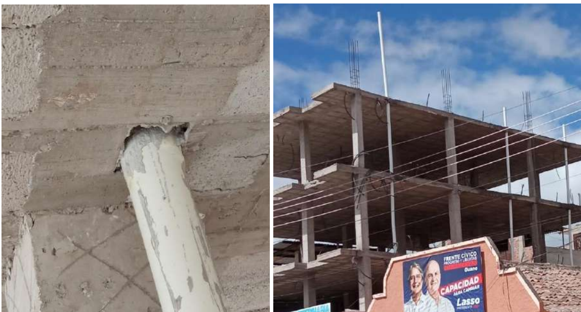
Figura 14.- Tuberías bajantes atravesando vigas banda, en edificaciones en construcción Elaborado por: Rivera (2021)
