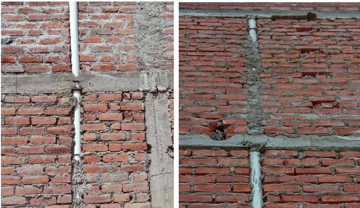
Figura 6.- Tubería atravesando una viga Elaborado por: Rivera (2021)
