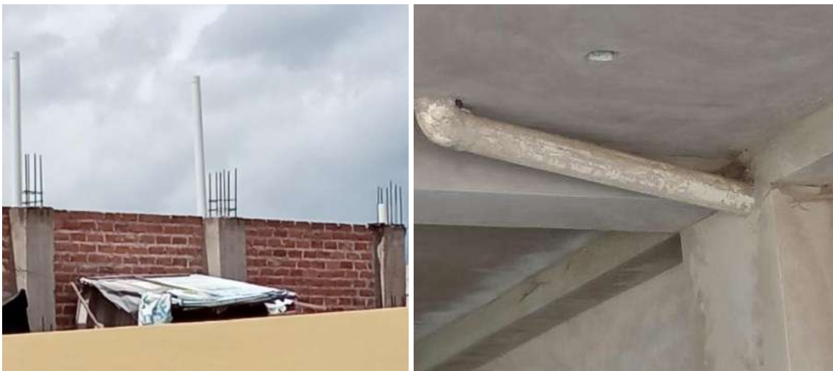
Figura 11.- Embebimiento de tuberías en columnas y cruce de tubería viga-columna Elaborado por: Rivera (2021)
