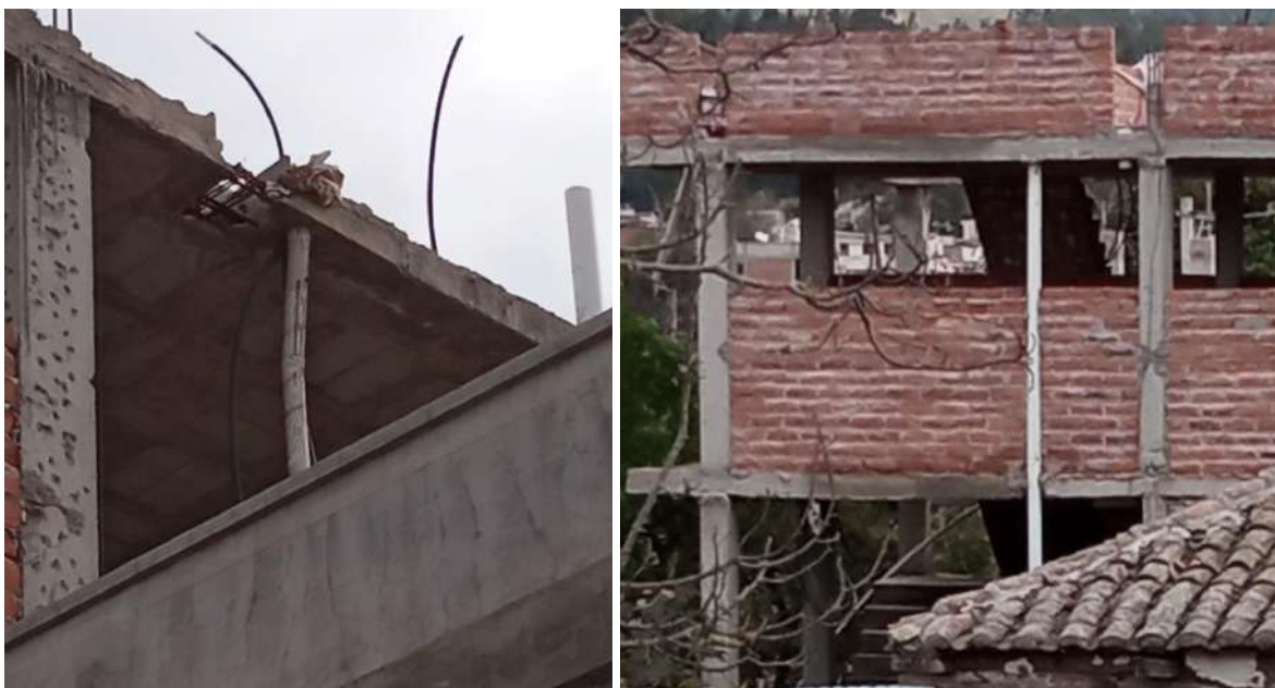
Figura 18.- Vigas atravesadas por tuberías Elaborado por: Rivera (2021)
