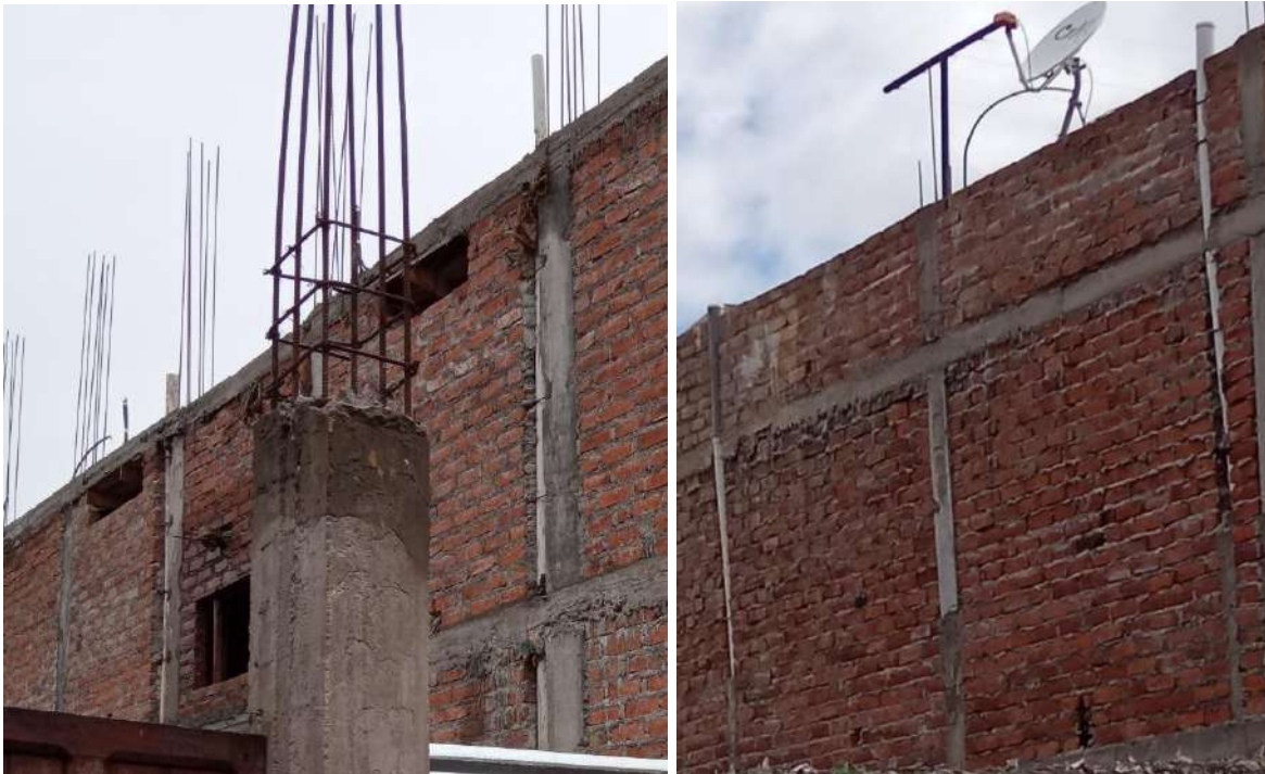
Figura 13.- Tuberías bajantes atravesando las vigas en la parroquia La Matriz Elaborado por: Rivera (2021)
