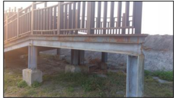
b) Rampa de acceso corroída
