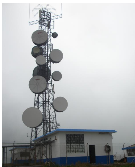
Figura IV. 31 Caseta tipo D 4x4m
