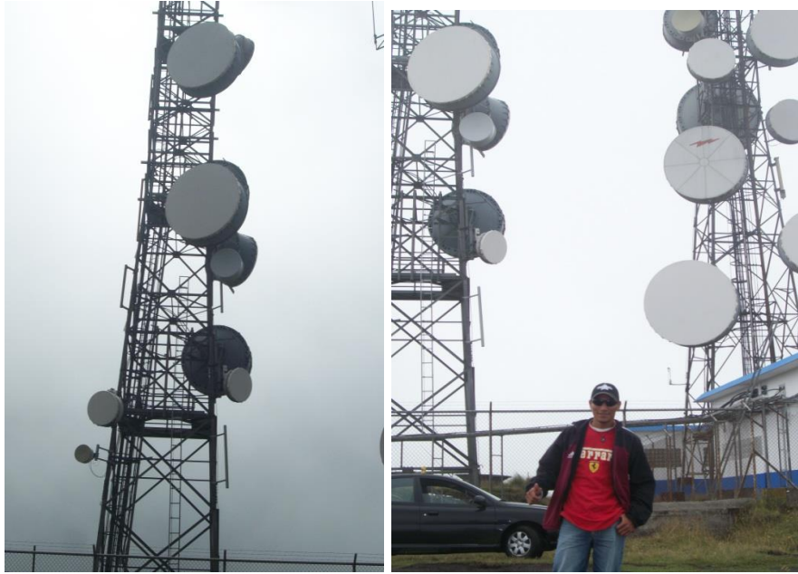
Figura 4.13. Antenas La Mira
