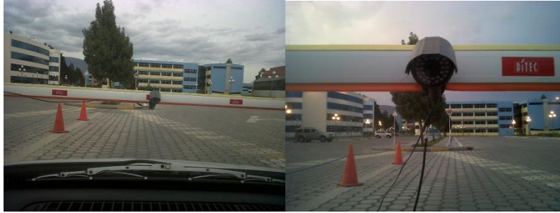
Figura 6.12 Pantalla de Instalación de Cámaras Autor: German Malan
