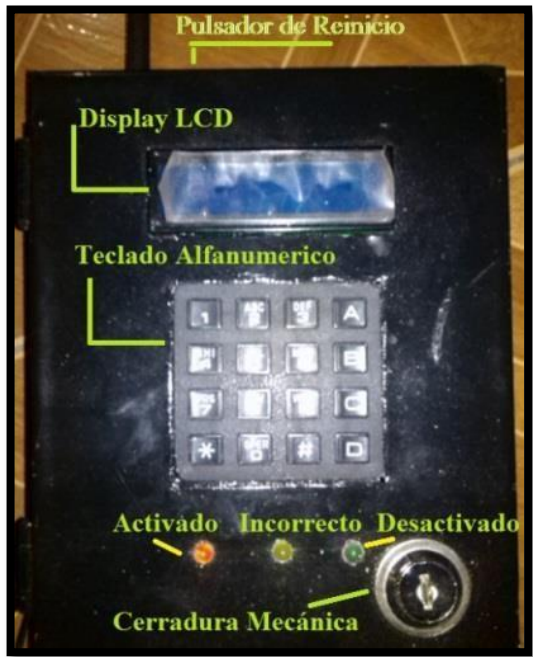
Figura 93. Vista Frontal del Circuito de Control Fuente: Autores
