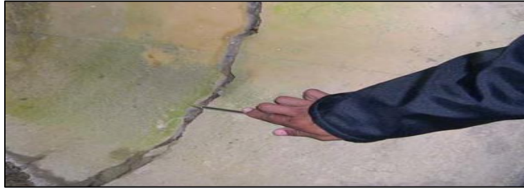
Ilustración 36. Grietas en la tubería de la alcantarilla.
