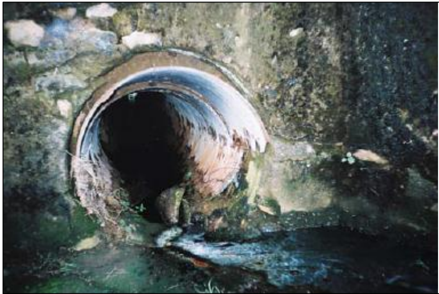
Ilustración 38. Fractura de la tubería.
