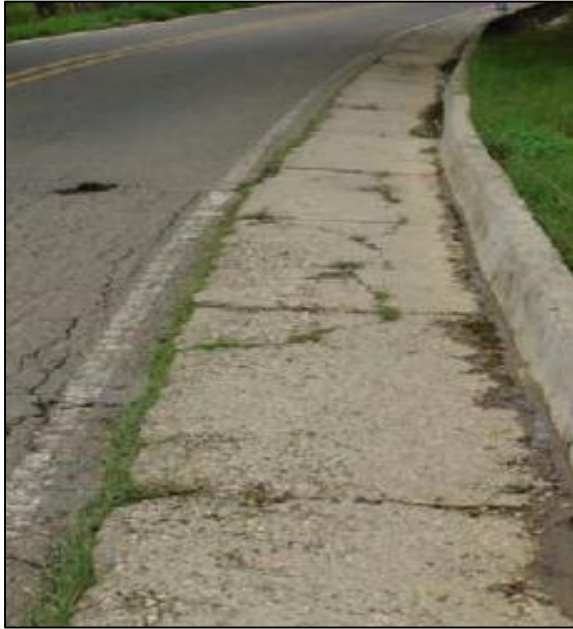
Ilustración 27. Grietas en cunetas.
