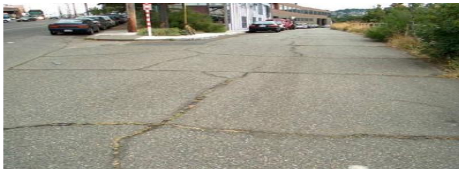
Ilustración 9. Grietas de reflexión de juntas de losa de concreto.
