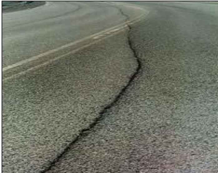
Ilustración 11. Grietas longitudinales y transversales.
