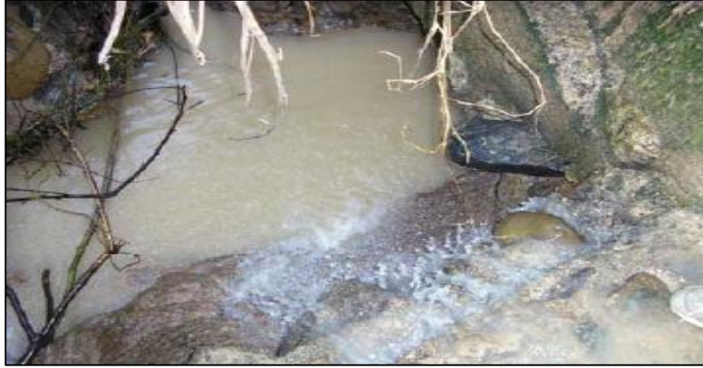
Ilustración 39. Fracturamientos de los canales de encole o descole. Fuente; Ministerio de Transporte, República de Colombia. 2010. Manual para la Inspección visual de Estructuras de drenaje. Bogotá.
