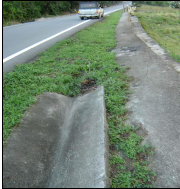
Ilustración 32. Cuneta que no entrega.
