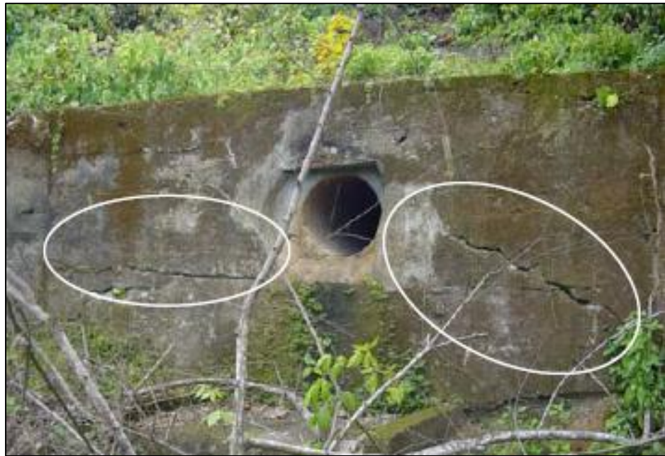
Ilustración 35. Fisuras del muro de una alcantarilla.
