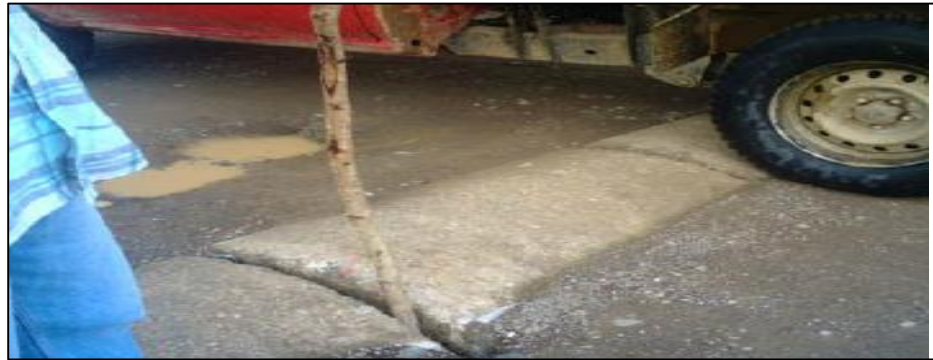
Ilustración 42. Exposición de tubería al tráfico.
