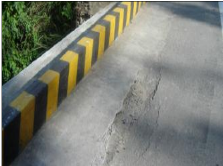
Ilustración 29. Desportillamiento de cunetas.
