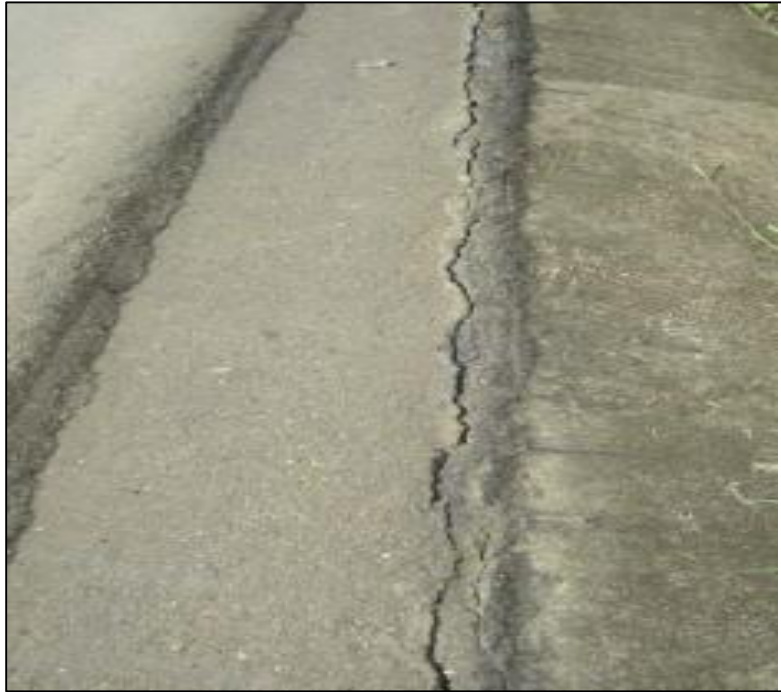
Ilustración 30. Separación de cuneta.
