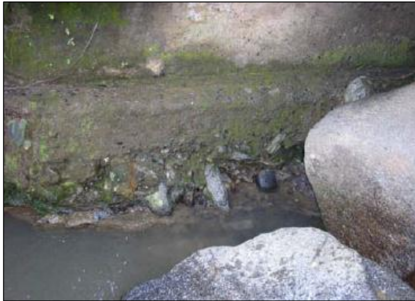
Ilustración 44. Socavación de concreto de las estructura de la alcantarilla. Fuente; Ministerio de Transporte, República de Colombia. 2010. Manual para la Inspección visual de Estructuras de drenaje. Bogotá.
