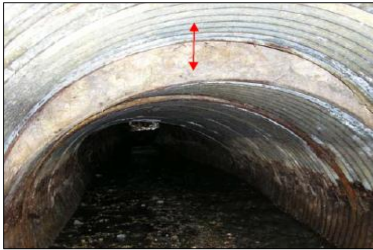
Ilustración 41. Hundimiento de tubería.
