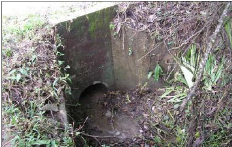
Ilustración 47. Alcantarilla sin mantenimiento.
