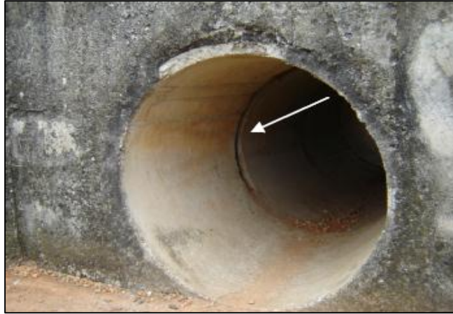
Ilustración 45. Pérdida de pega en las uniones de la tubería.
