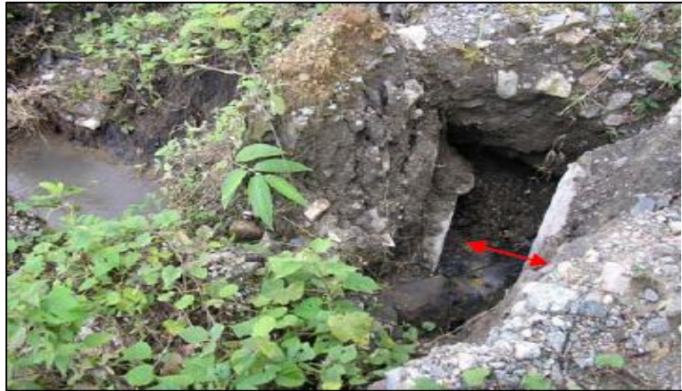
Ilustración 40. Separación de secciones de tubería. Fuente; Ministerio de Transporte, República de Colombia. 2010. Manual para la Inspección visual de Estructuras de drenaje. Bogotá.
