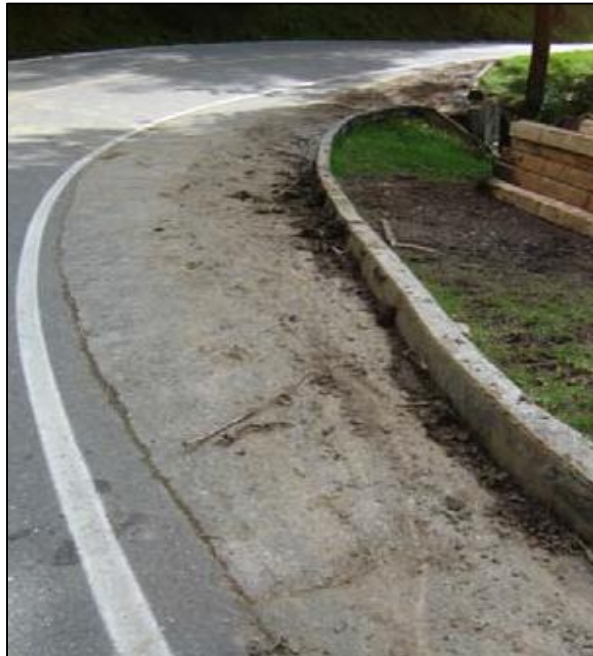
Ilustración 31. Obstrucción de cunetas.
