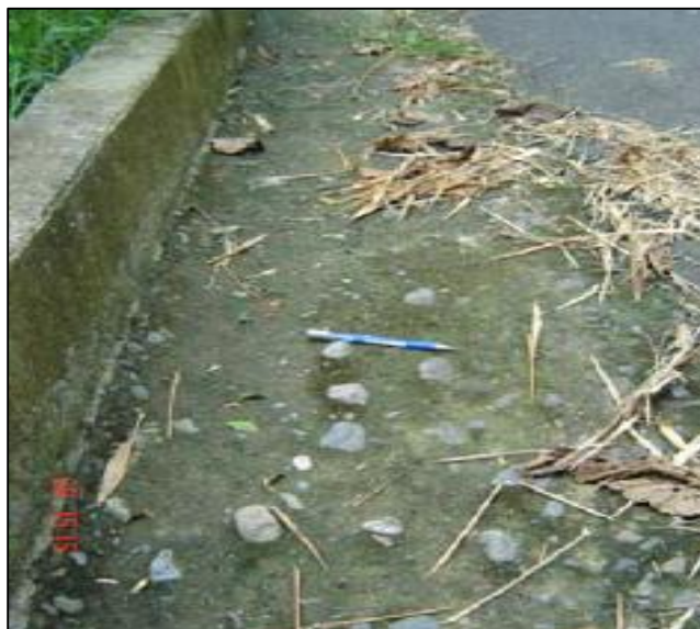
Ilustración 28. Desgaste en cunetas.
