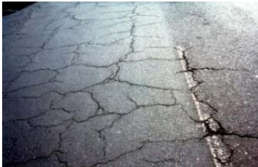
Ilustración 4. Grietas de Contracción.
