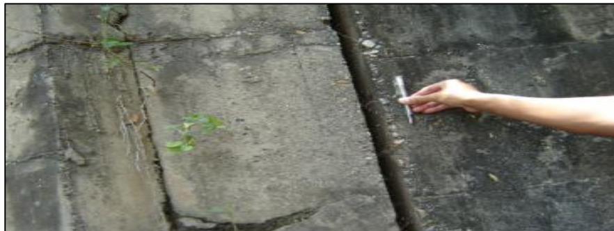
Ilustración 37. Grietas verticales en la unión de los muros el cabezal.
