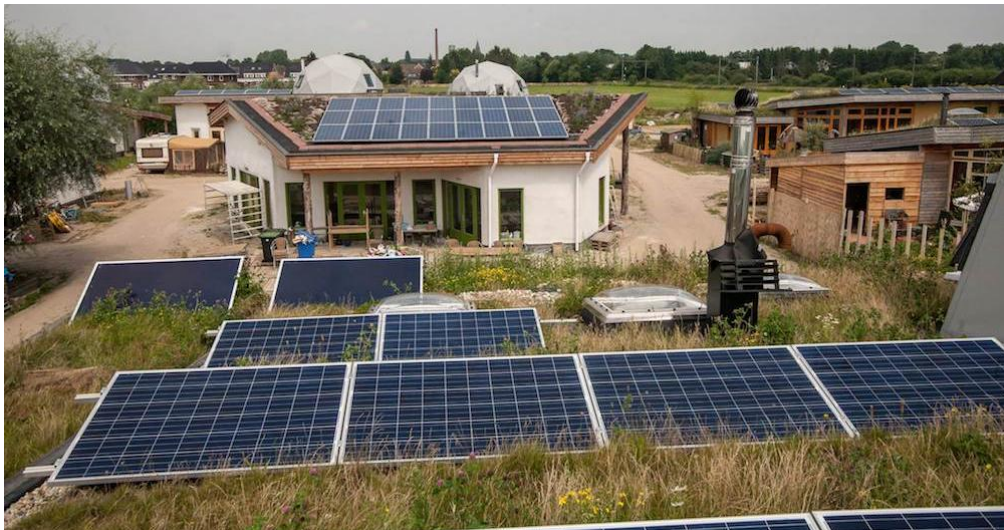
Ilustración 3 Sistema de Energía solar Fuente: ecoinventos.com
