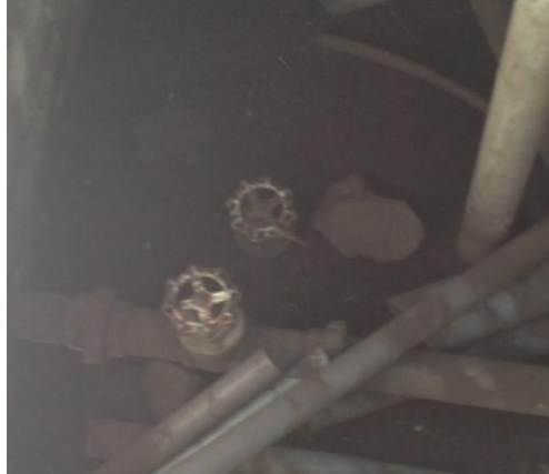
Foto 15. Válvulas reguladoras para la conducción y el retro lavado del tanque de almacenamiento Fuente: Autor
