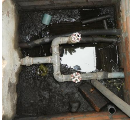
Foto 11. Válvulas reguladoras para la red de distribución y el retro lavado. Fuente: Autor
