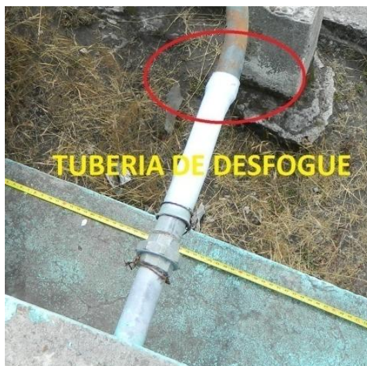
Foto 26. Tuberías conectadas en el sistema de desfogue que es conducida al tanque de almacenamiento.
