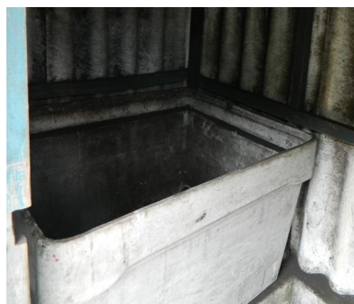
Foto 13. Tanque de cloración (500 lt) Fuente: Autor
