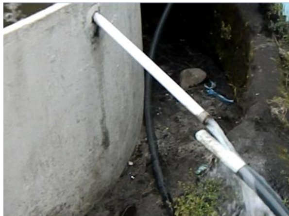
Foto 25. Tuberías de desfogue que son aprovechadas mediante tubería que conduce hacia el tanque de almacenamiento para la red de distribución. Fuente: Autor
