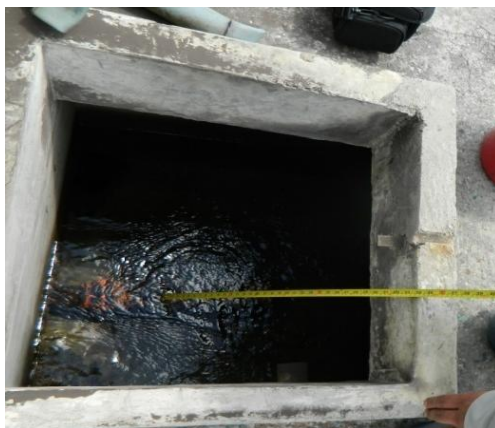
Foto 12. Caja Recolectora de agua Fuente: Autor
