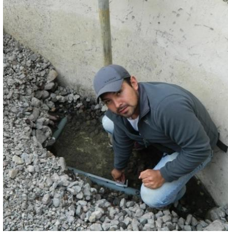
Foto 8. Tuberías perforadas al fondo del tanque filtrador Fuente: Autor
