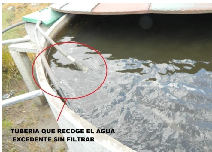
Foto 28. Tubería que recoge agua del tanque filtrador sistema Yaguachi Fuente: Autor
