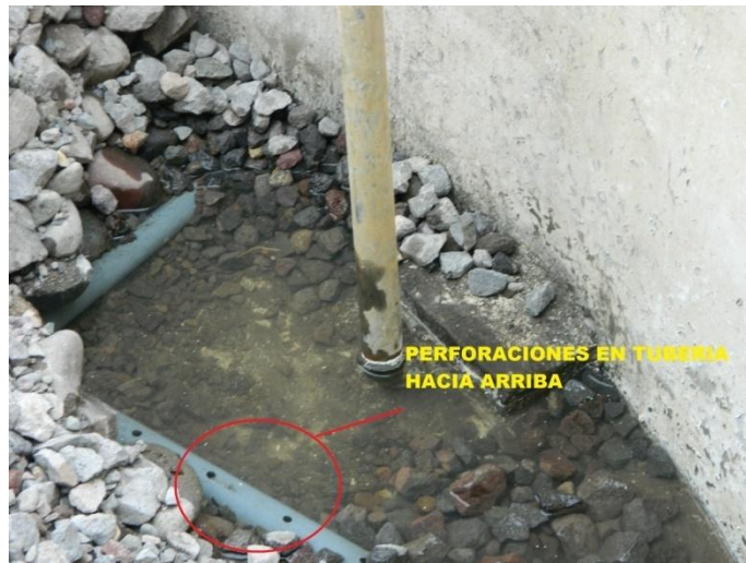
Foto 31. Tubería mal perforada sistema Yaguachi Fuente: Autor
