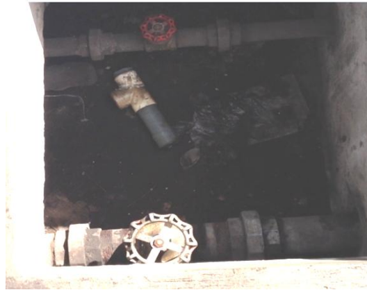
Foto 3. Válvulas reguladoras para el retro lavado Fuente: Autor
