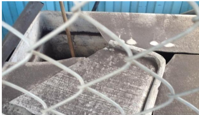
Foto 23. Tanque dosificador que se encuentra totalmente inhabilitado y destruido. Fuente: Autor
