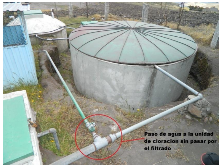
Foto 30. Unidad de cloración mal colocada Fuente: Autor
