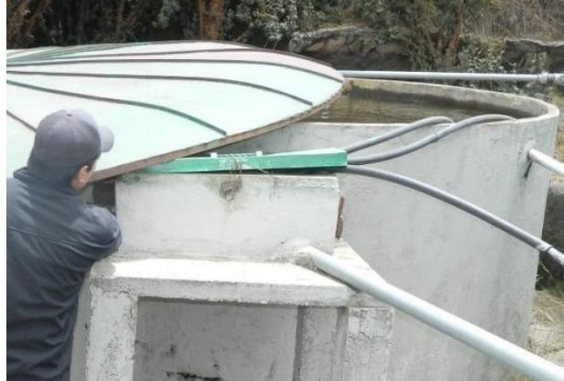
Foto 24. Tanque filtrador donde se aprecia la tubería que recoge el agua en exceso del tanque filtrador para pasarlo directamente hacia la caja del vertedero Fuente: Autor
