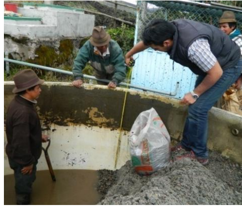
Foto 7. Arena Tanque de Filtración Fuente: Autor
