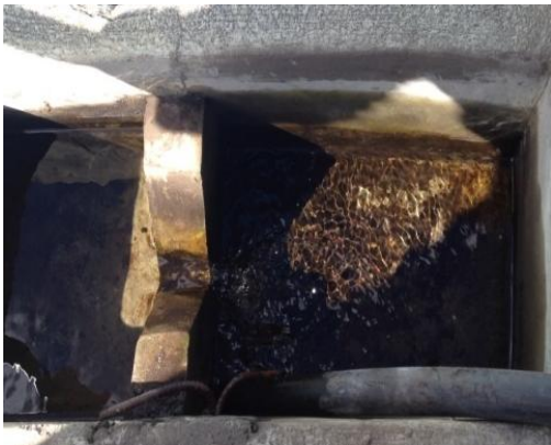
Foto 9. Vertedero tipo triangular Fuente: Autor
