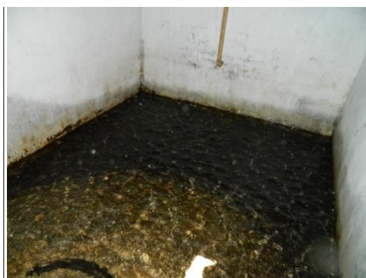
Foto 14. Tanque de almacenamiento Yanarumi
