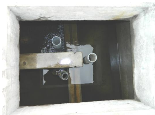
Foto 2. Tuberías de desfogue en la caja de recolección de agua Fuente: Autor
