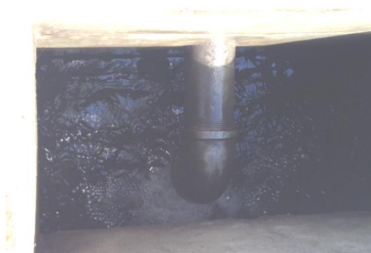
Foto 1. Tubería HG 4” que llega a la planta desde la captación. Fuente: AUTOR
