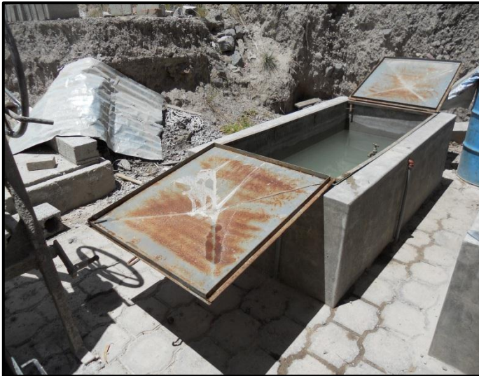
Figura 31: Tanque de curado
