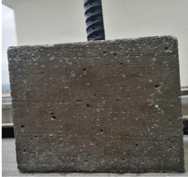
Figura N° 3.- Cubo de Hormigón con pequeñas burbujas Elaborado por: Velásquez S. Jordy J.
