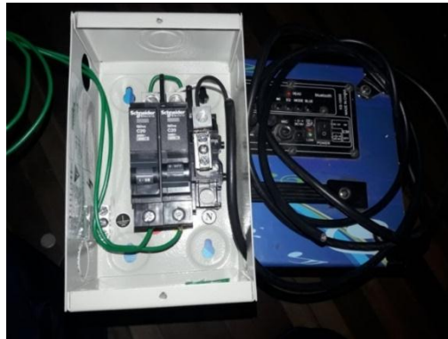
GRAFICO N° 8 Fotografía caja térmica
