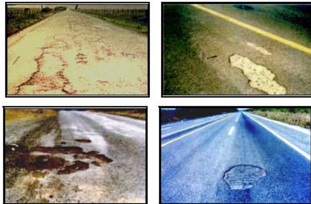
Gráfico 4: Segregación en pavimentos asfálticos.
