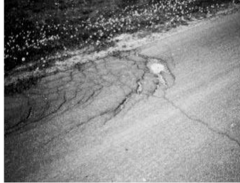
Gráfico 33: Grietas de resbalamiento
