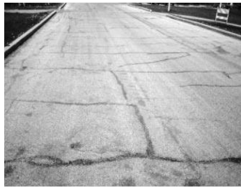
Gráfico 35: Grietas de bloque.
