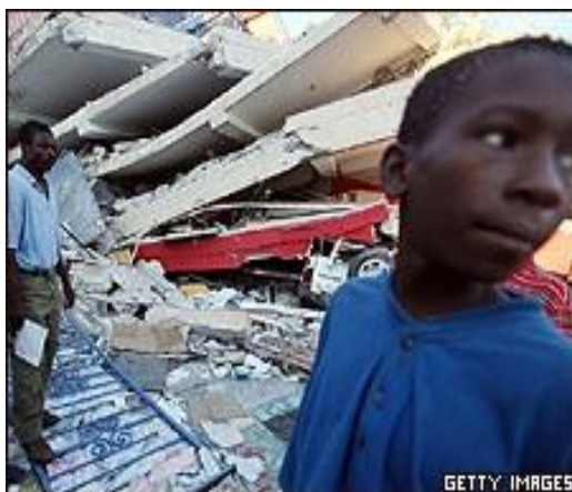
Figura 3. Edificio destruido en Puerto Príncipe.
