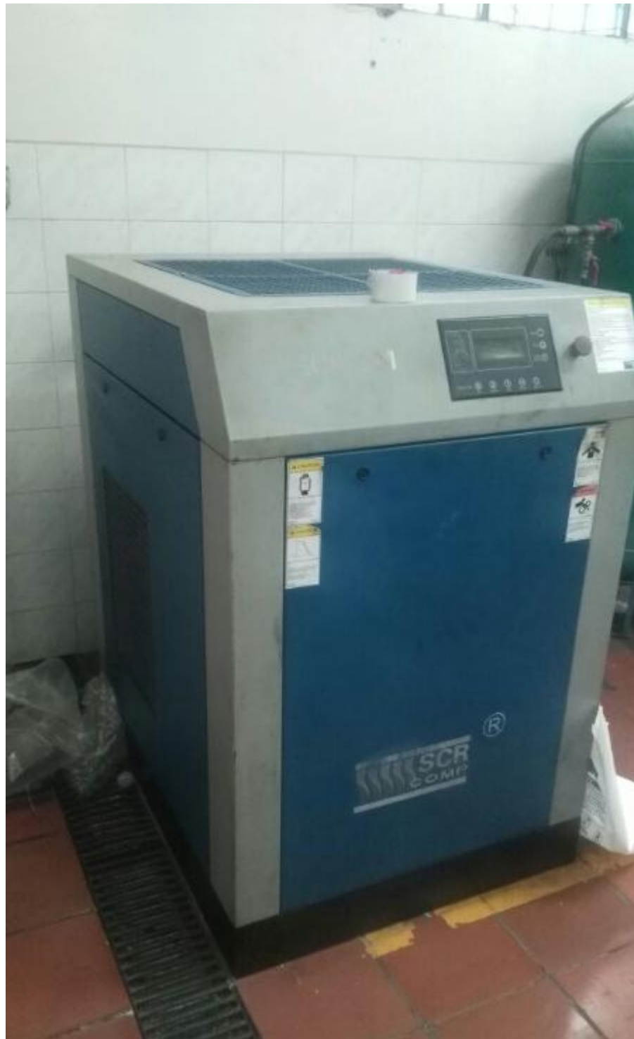
Ilustración 3.8.3- Compresor de tornillo 15 hp.
