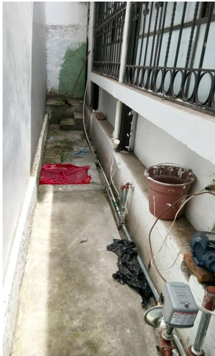
Anexo. 3.5: Orden y limpieza deficiente.
