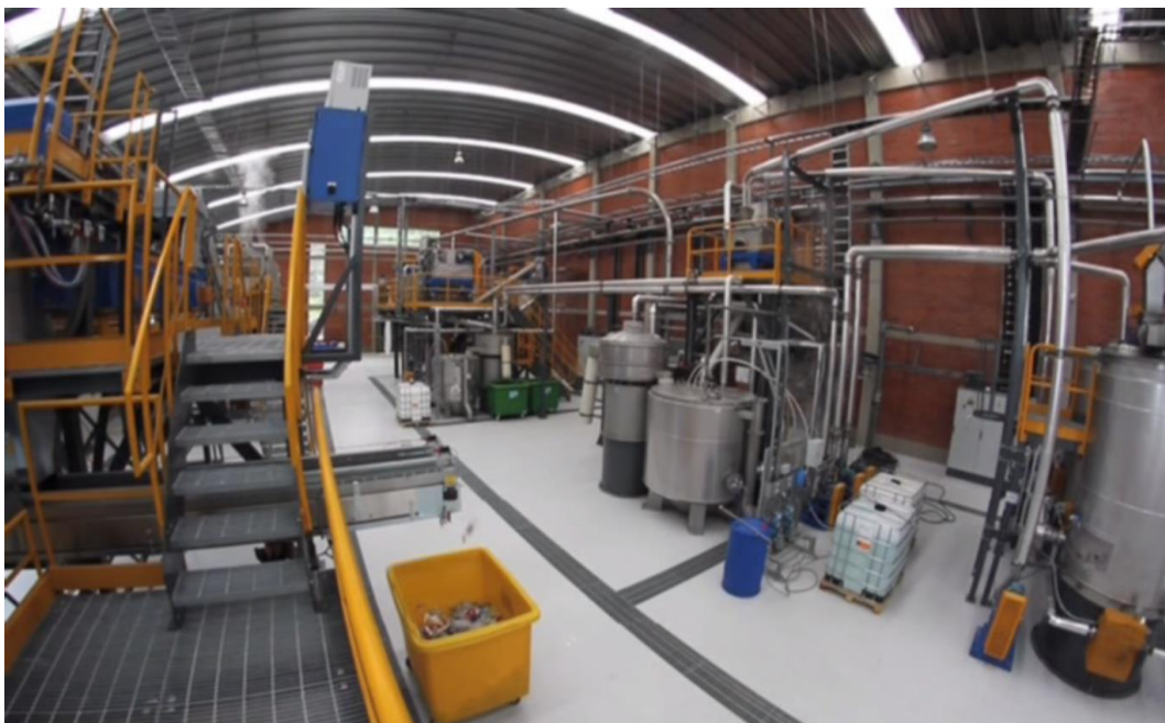
Figura 11: Planta de producción de escama de pet reciclado “SOREMA”
