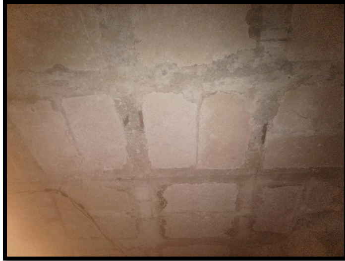
PRINCIPALES FALLAS EN EDIFICIOS
