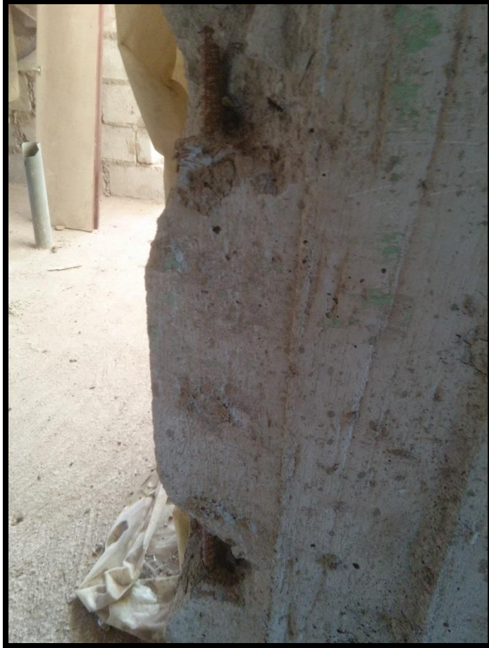
PRINCIPALES FALLAS EN EDIFICIOS
