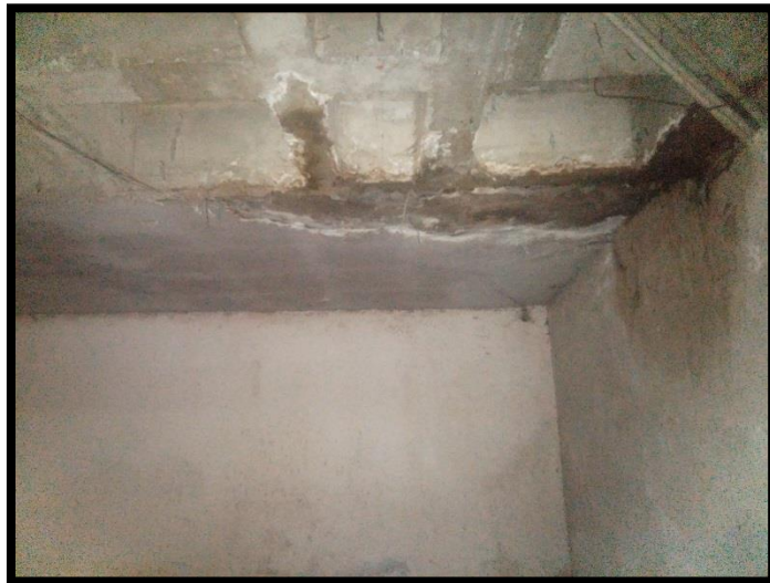
PRINCIPALES FALLAS EN EDIFICIOS
