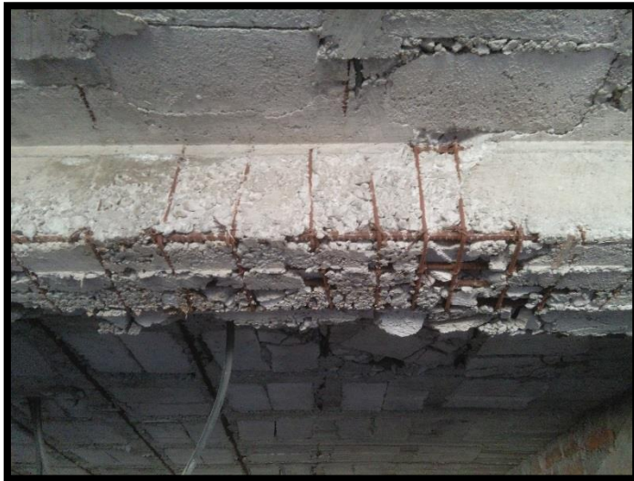
PRINCIPALES FALLAS EN EDIFICIOS
