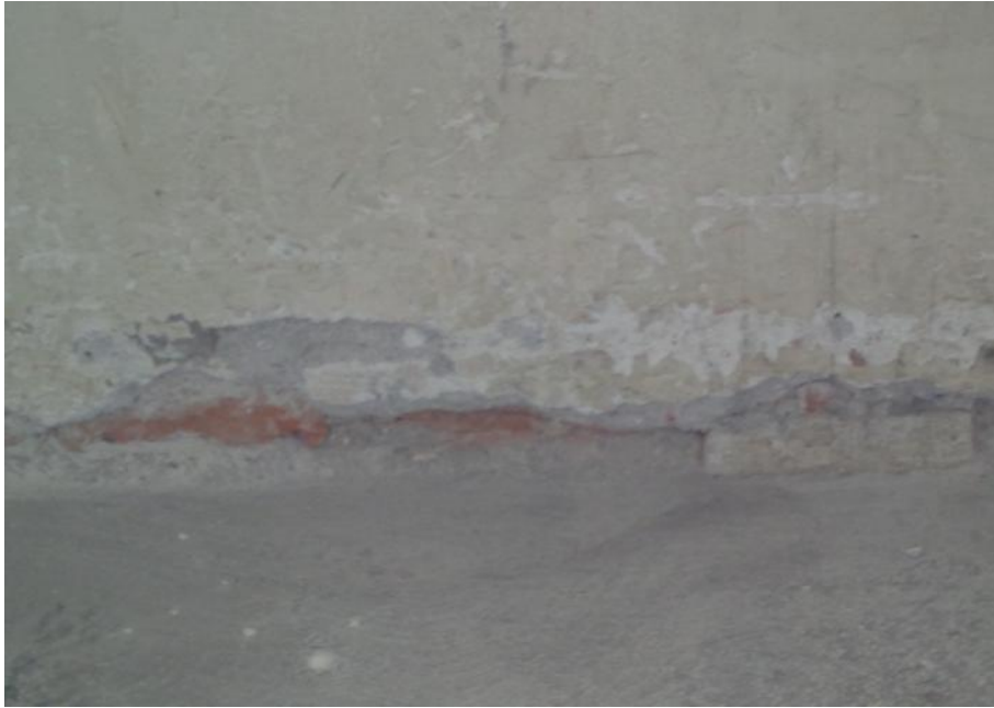
Fotografía N° 3 Unión de piso y pared
