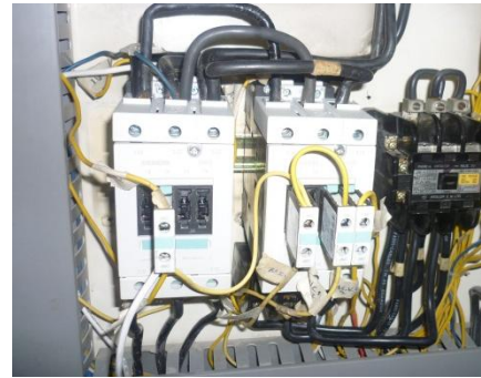
Contactores de los Molinos
