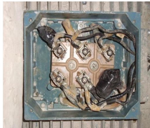
Fig. 13 Mantenimiento de borneas.
