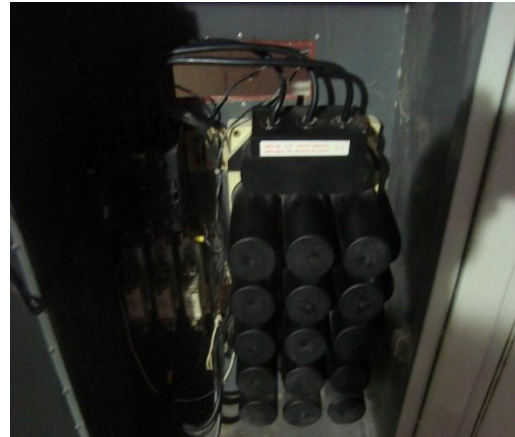
Fig. 9 Banco de condensadores ( Después ).
