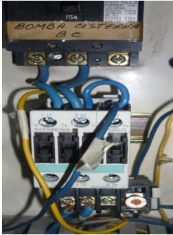
Contactor de Cisterna
