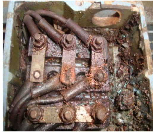
Fig. 24 Motor Ventilador del Silo.
