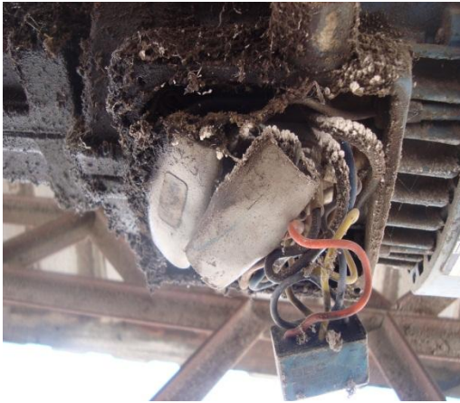
Fig. 23 Motor del Ascensor.
