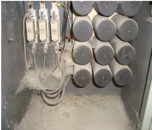
Fig. 8 Banco de condensadores ( Antes ).
