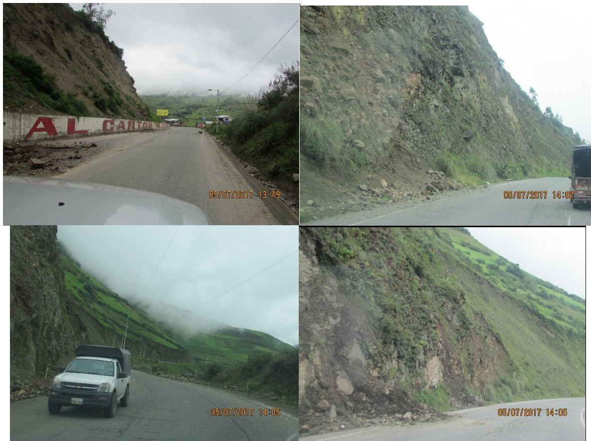
Problemas por deslizamiento de taludes
