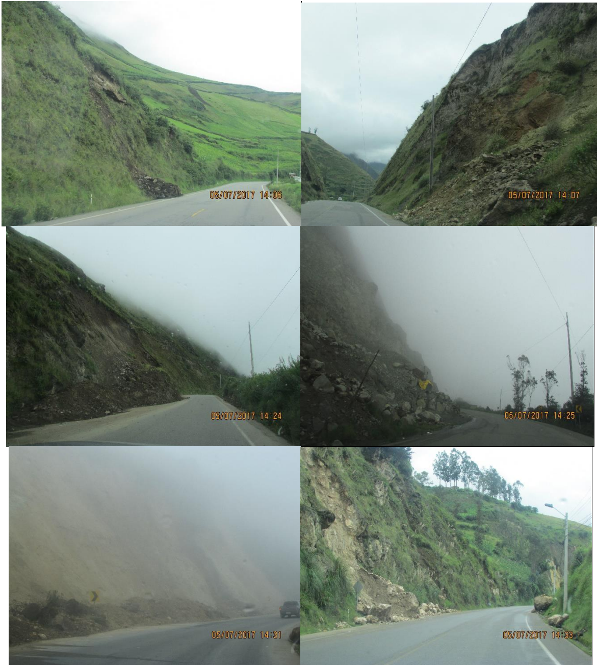
Problemas por deslizamiento de taludes
