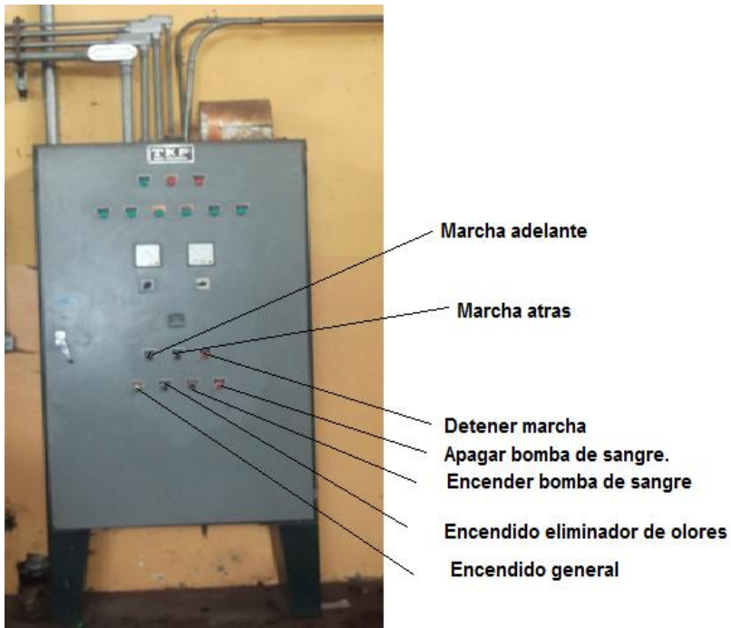
Figura: 22. Tablero de control de la fábrica. Fuente: C.F.M.R.
