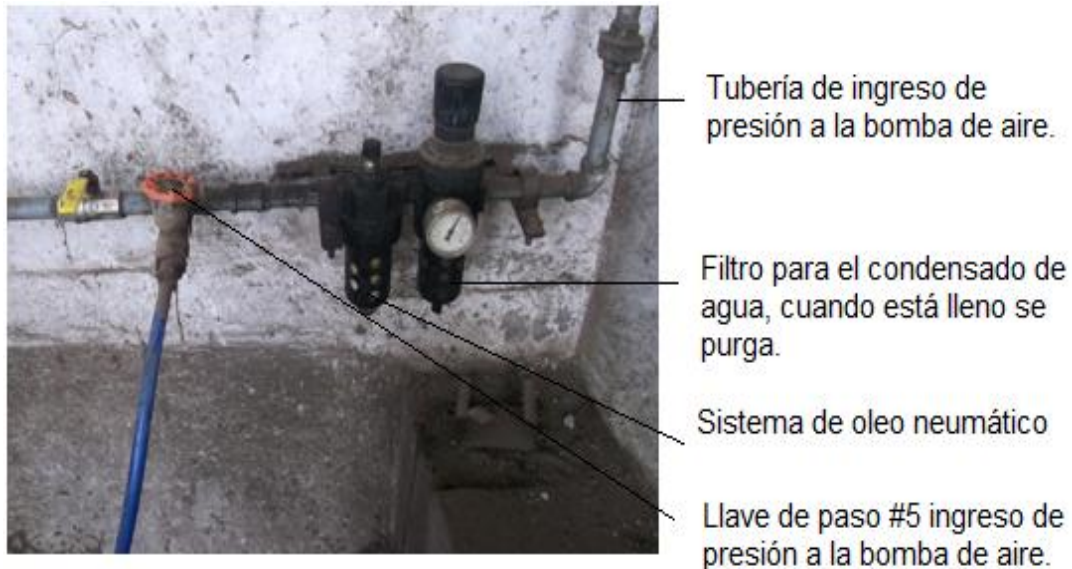
Figura: 17. Tubería y llave de ingreso de presión a la bomba de diafragma. Fuente: C.F.M.R.
