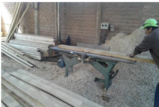
5. Falta de EPP.
