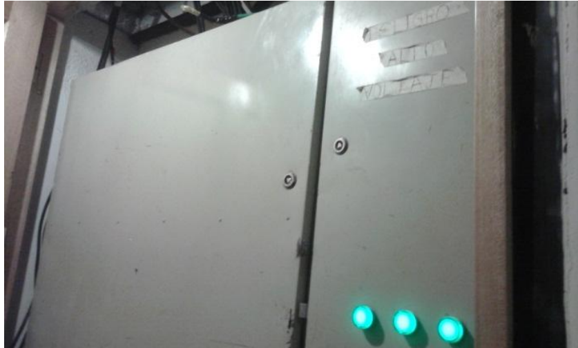
31 Registro fotográfico de falta de señalética
