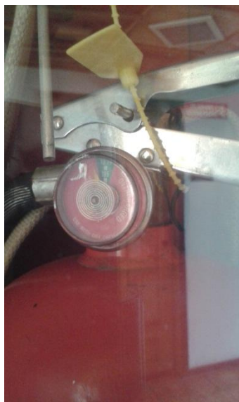
30 Registro fotográfico de extintores sin presión
