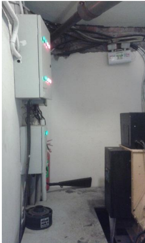
32 Registro fotográfico del cuanto del generador
