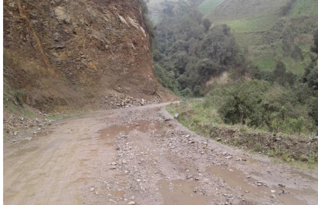
Ilustración 19. Inestabilidad en taludes.
