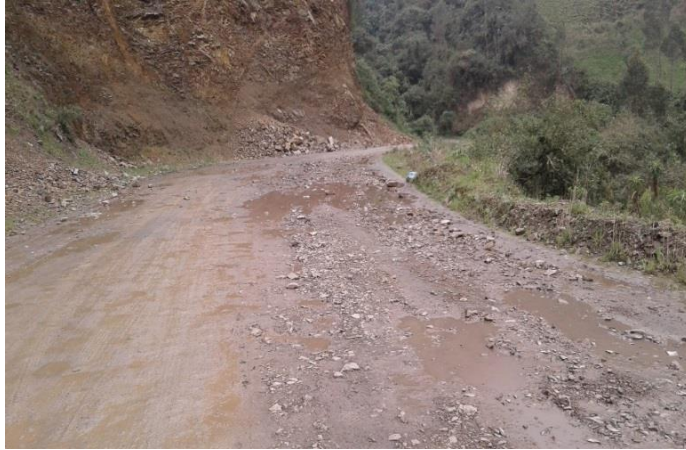
Ilustración 16. MATERIAL PROVENIENTE DEL TALUD EN LA SUPERFICIE DE RODAMIENTO.
