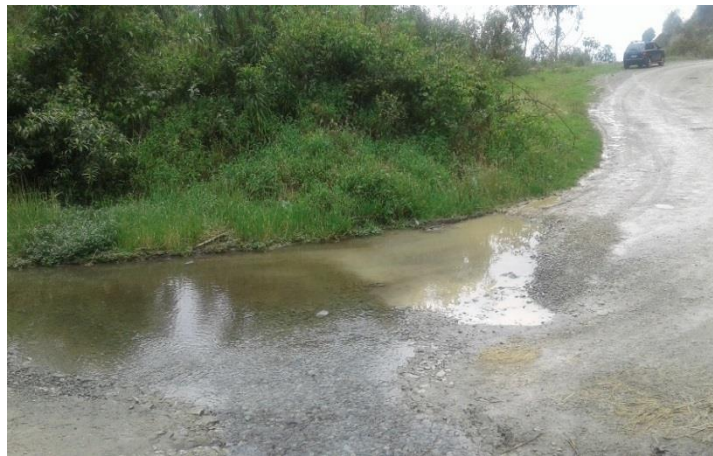
Ilustración 18. FALLAS OCASIONADAS POR LA INEXISTENCIA DE SISTEMAS DE DRENAJE.
