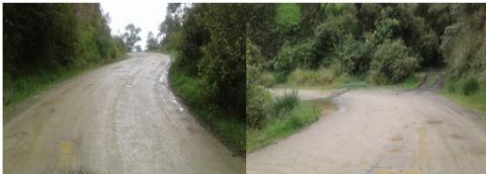
Ilustración 20. FALTA DE SEÑALIZACIÓN.
