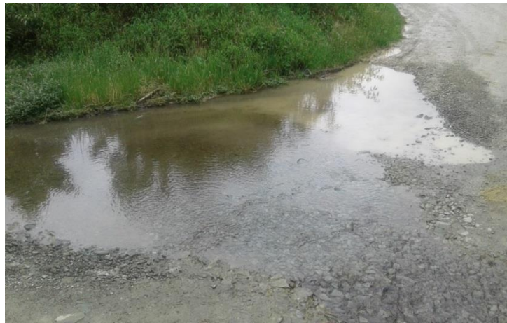
Ilustración 15. PRESENCIA DE AGUA EN LA SUPERFICIE DE RODADURA.
