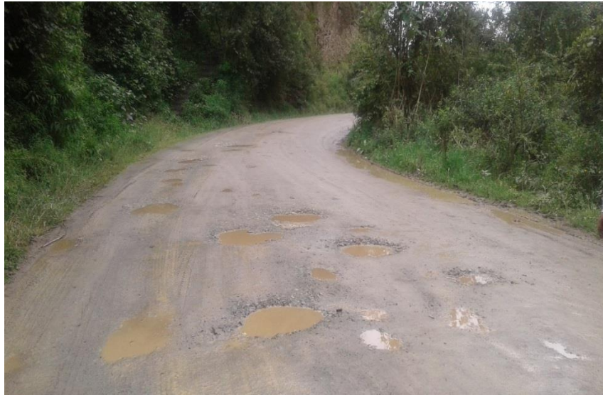
Ilustración 8. ESTADO DE LA SUPERFICIE DE RODAMIENTO.
