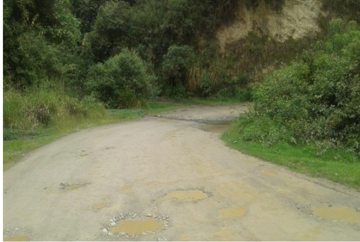
Ilustración 13. PRESENCIA DE AGUA EN LA VÍA, PROVOCANDO BACHES.
