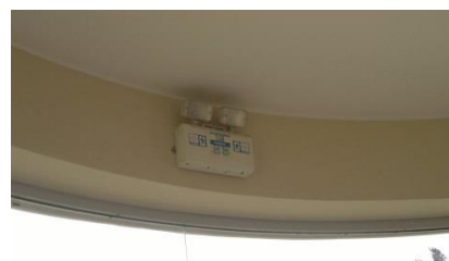
Ilustración 15: Luces de emergencia
