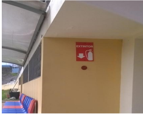
Figura 6: Pictograma de seguridad, Equipo de protección contra incendio
