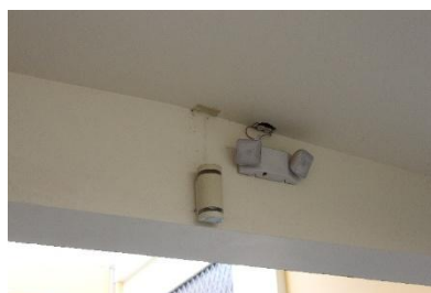
Figura 15: luces de Emergencia
