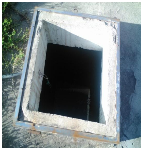
Anexo 11: Cisterna del edificio CTE.
