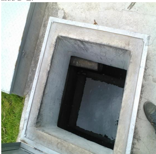
Anexo 6: Cisterna de la Facultad de Ciencias de la Salud D-E.
