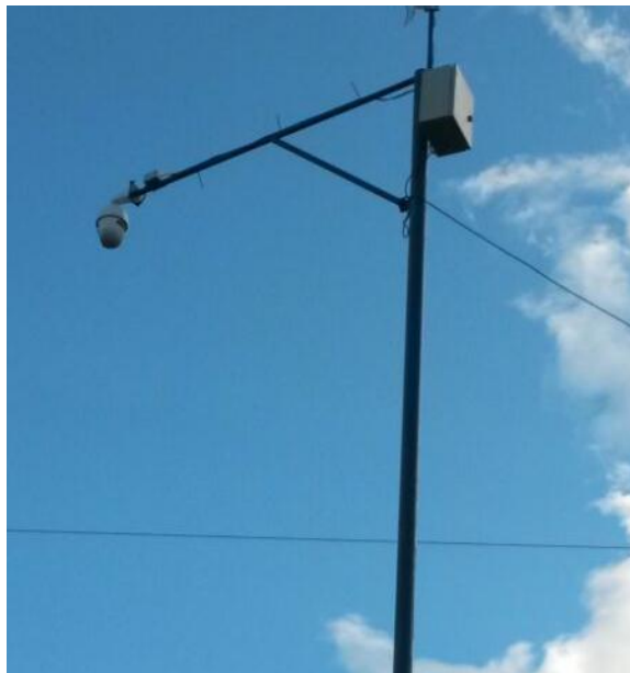
Figura 28. Caja de paso instalada en el poste Fuente: Los autores.
