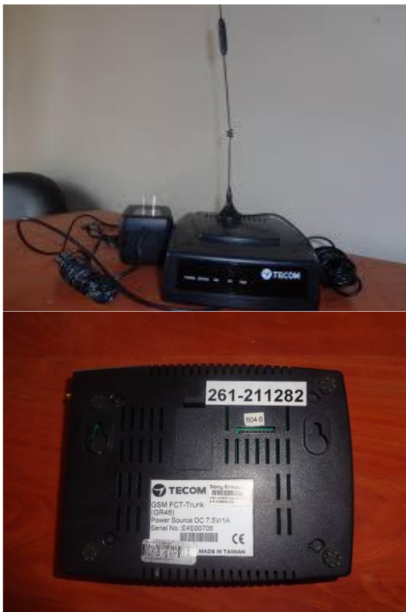
Figura 12. Base celular TECOM – MODEM GR48 Fuente: Autores
