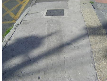
Ilustración 1. Acera de hormigón
