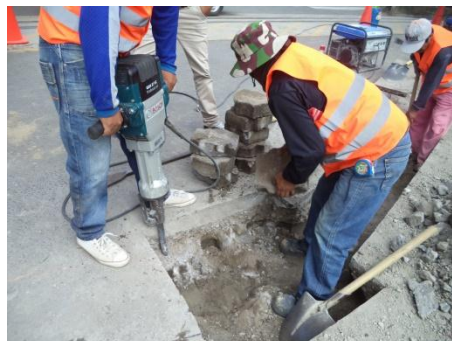
Ilustración 3. Rotura de acera existente
