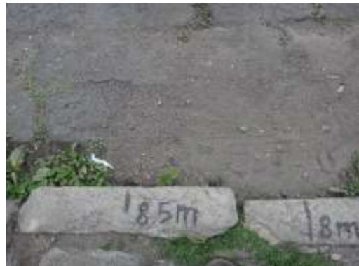
Ilustración 43. Perdida de arena, severidad alta Fuente: Autores del estudio
