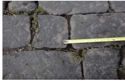
Ilustración 45. Juntas abiertas, severidad media Fuente: Autores del estudio
