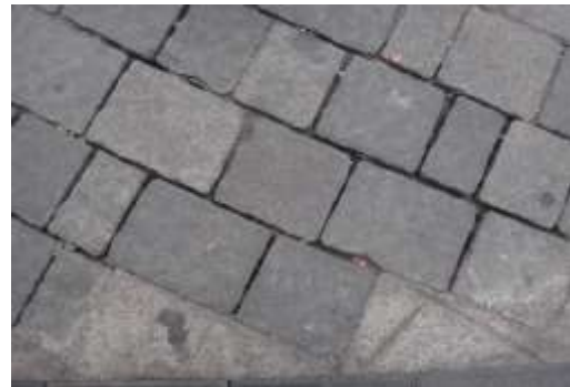
Ilustración 53. Perdida de arena, severidad media Fuente: Autores del estudio
