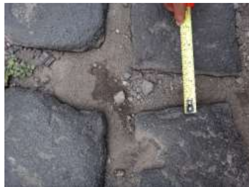
Ilustración 33. Juntas abiertas, severidad alta Fuente: Autores del estudio
