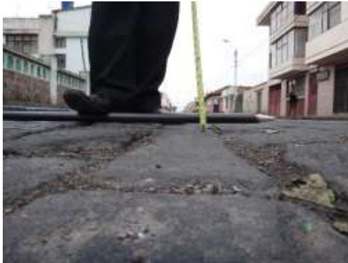
Ilustración 40. Abultamiento, severidad media Fuente: Autores del estudio
