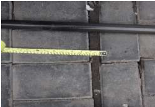
Ilustración 52. Juntas abiertas, severidad media Fuente: Autores del estudio
