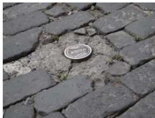
Ilustración 31. Confinamiento Interno, severidad alta Fuente: Autores del estudio
