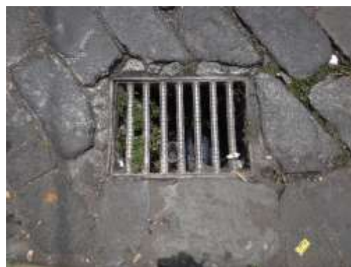
Ilustración 37. Confinamiento, severidad alta Fuente: Autores del estudio
