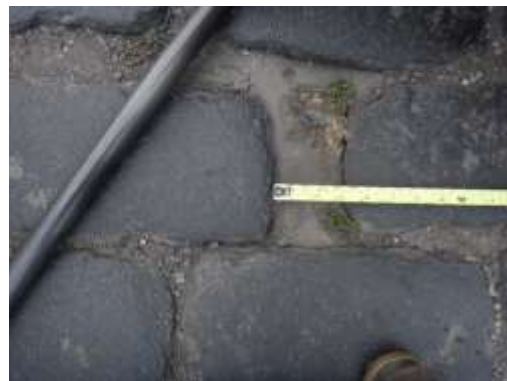
Ilustración 25. Juntas abiertas, severidad alta Fuente: Autores del estudio
