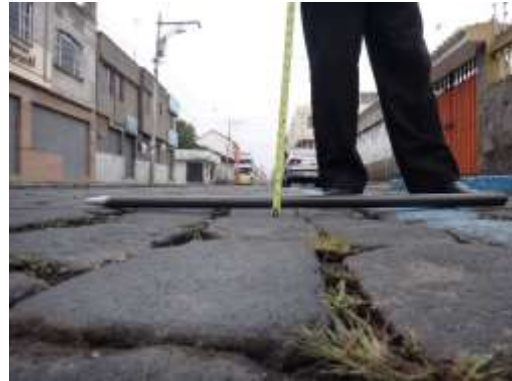
Ilustración 41. Depresión, severidad media Fuente: Autores del estudio
