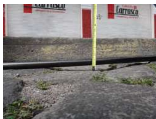
Ilustración 31. Depresión, severidad media Fuente: Autores del estudio
