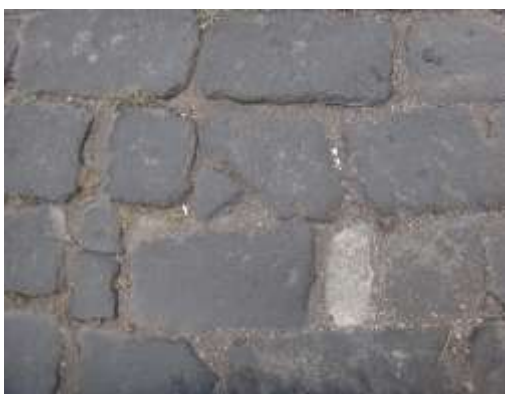
Ilustración 28. Fractura, severidad baja Fuente: Autores del estudio
