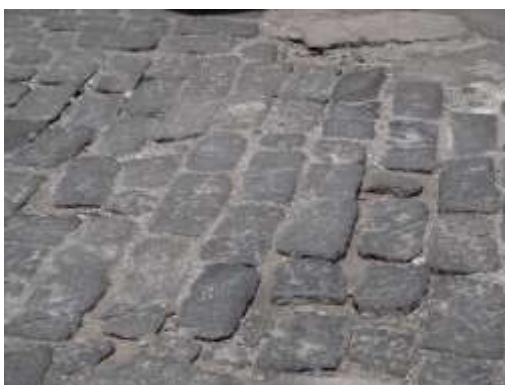
Ilustración 36. Fractura, severidad baja Fuente: Autores del estudio
