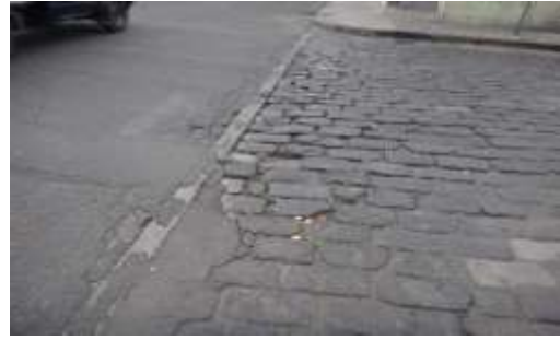
Ilustración 39. Juntas abiertas, severidad alta Fuente: Autores del estudio
