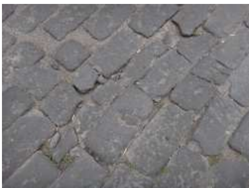
Ilustración 30. Fractura, severidad baja Fuente: Autores del estudio
