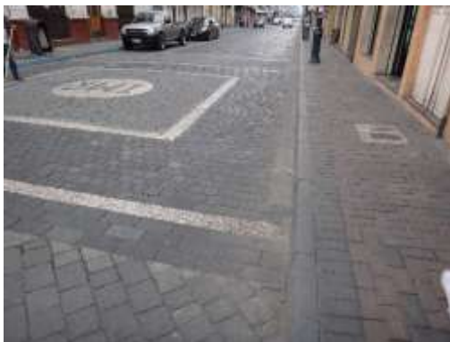
Ilustración 58. Confinamiento interno, severidad baja Fuente: Autores del estudio
