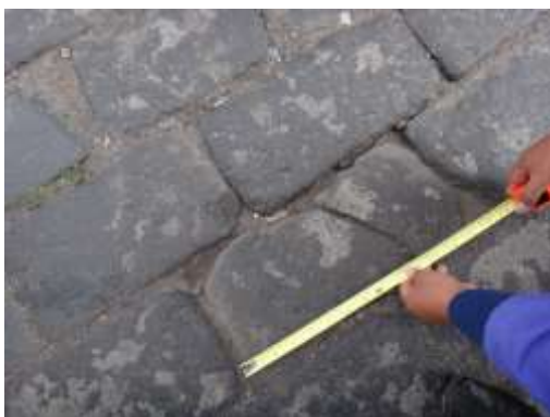
Ilustración 22. Fractura, severidad baja Fuente: Autores del proyecto
