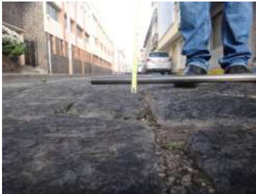
Ilustración 46. Abultamiento, severidad media Fuente: Autores del estudio
