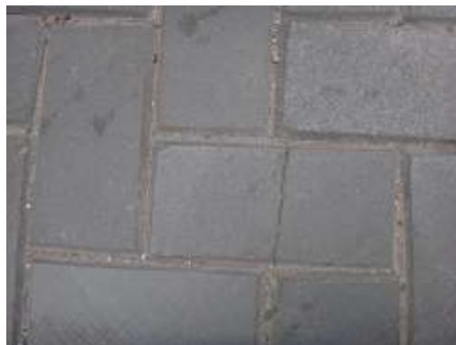
Ilustración 60. Fractura, severidad baja Fuente: Autores del estudio
