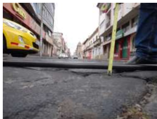
Ilustración 27. Depresión, severidad media Fuente: Autores del estudio
