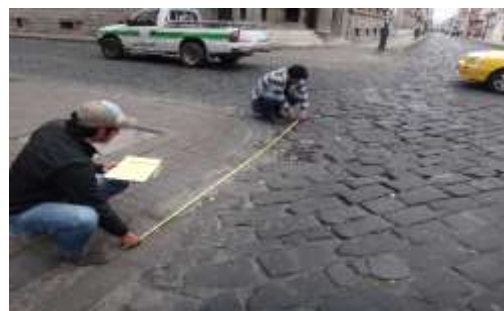
Ilustración 29. Juntas abiertas, severidad alta Fuente: Autores del estudio
