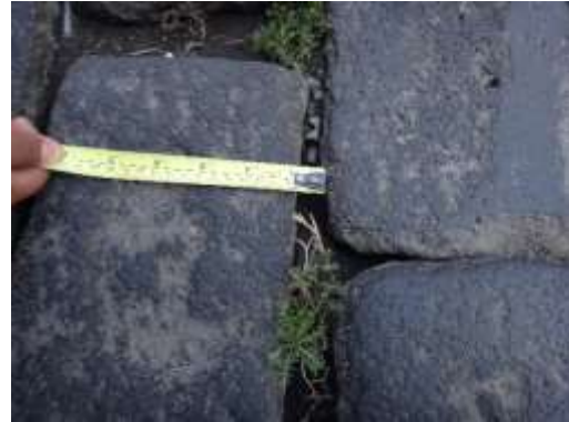
Ilustración 19. Juntas abiertas, severidad Fuente: Autores del proyecto
