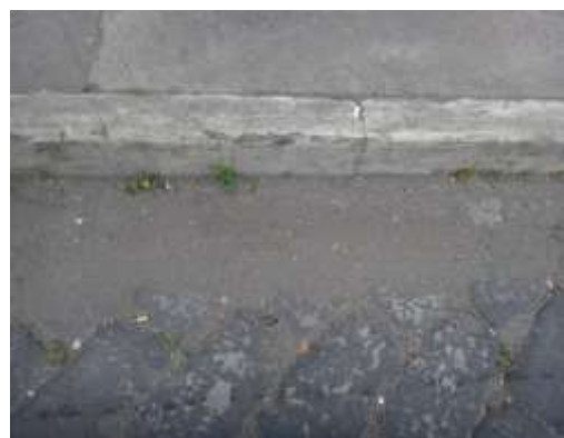
Ilustración 29. Perdida de arena, severidad alta Fuente: Autores del estudio
