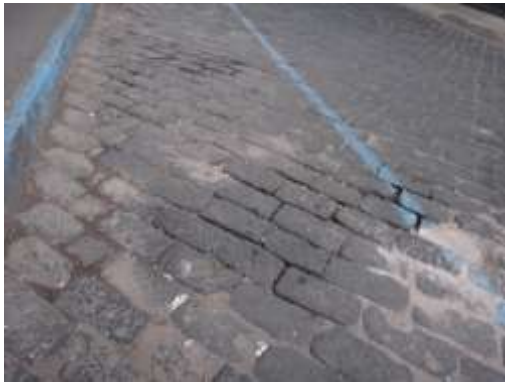
Ilustración 20. Abultamiento, severidad alta Fuente: Autores del proyecto
