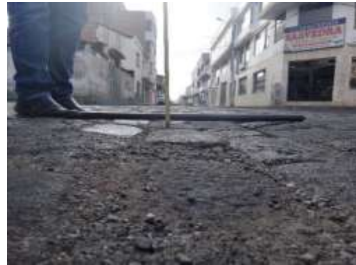
Ilustración 47. Depresión, severidad media Fuente: Autores del estudio
