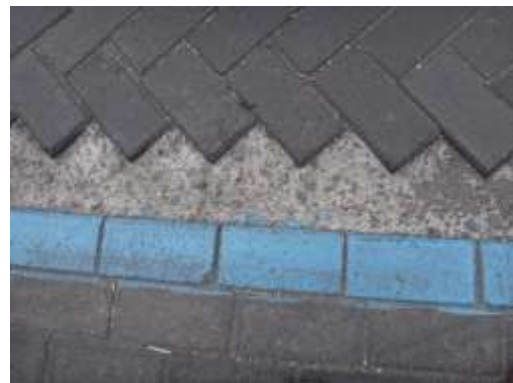
Ilustración 59. Perdida de arena, severidad media Fuente: Autores del estudio
