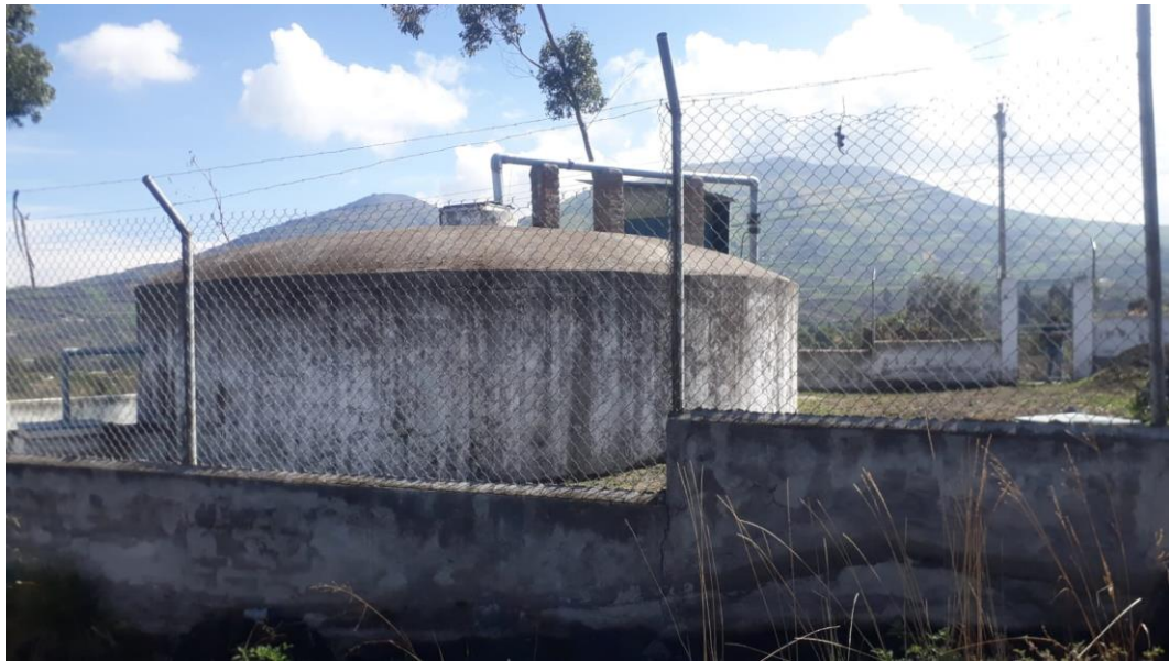
Planta de tratamiento – El Empalme
