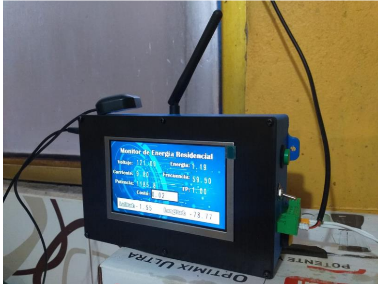
Figura 32 Instalación completa del transmisor.
