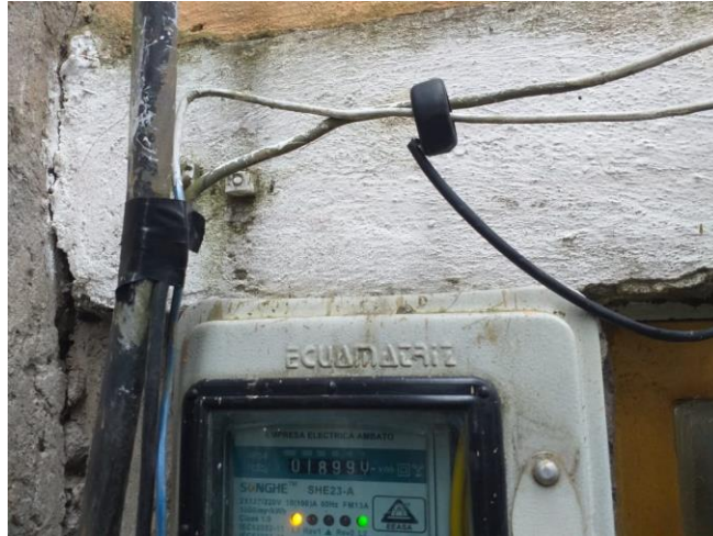
Figura 30 Instalación del sensor PZEM-004T-100A.
