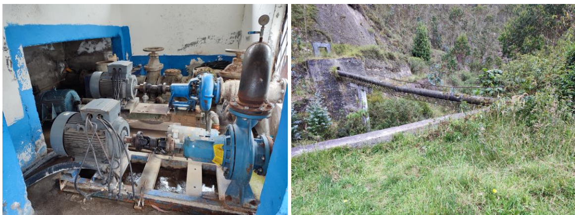
Figura 3: Estación de bombeo de Huayrapata
