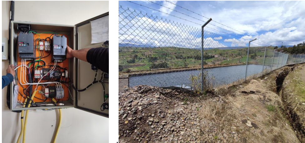
Figura 4: Estación de bombeo de Yatchil
