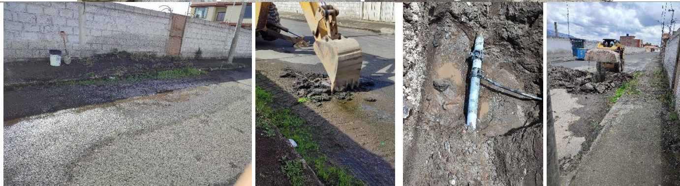
Rotura del collarín de distribución
