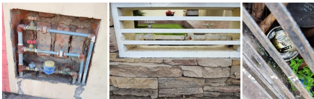
Figura 12: Acometidas sin medidor o medidor dañado
