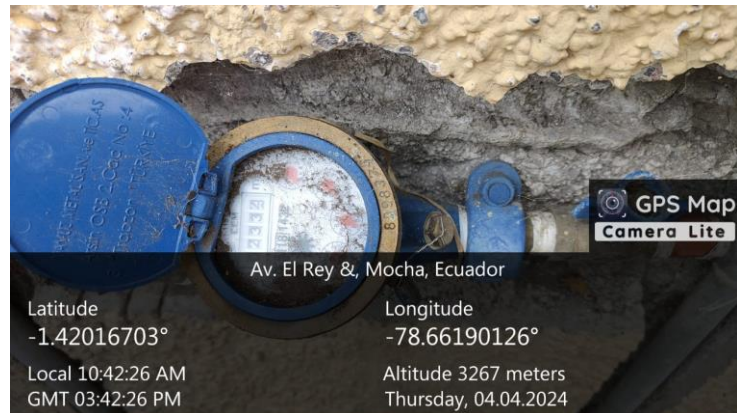
Imagen 4: Medidor Zona Centro.
