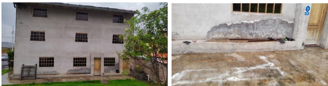
Figura 37. Estado de la pared
