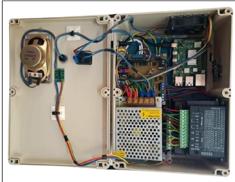
Figura 30: Implementación del Sistema Electrónico. Fuente: Autor.
