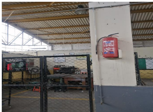
Extintor en taller B1
