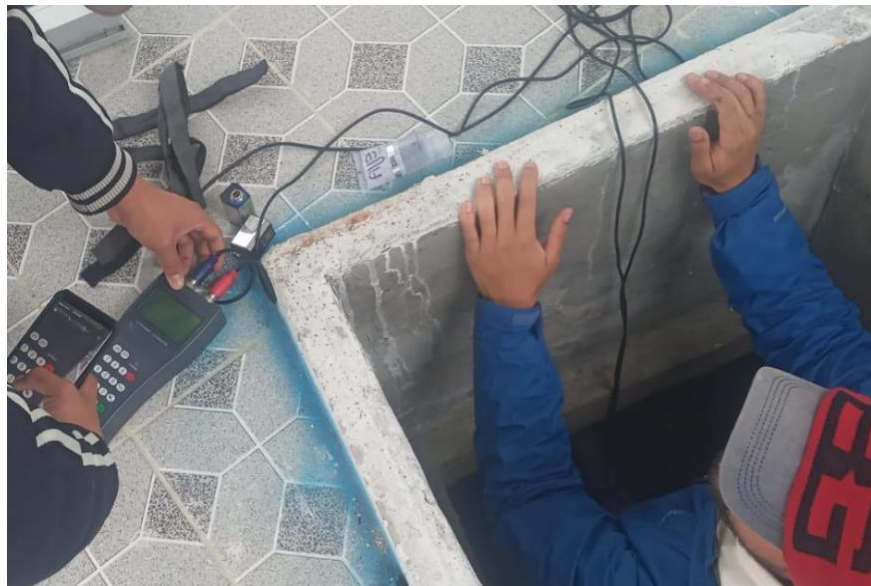
Figura 10. Caudalímetro Ultrasónico conectado en la red de distribución
