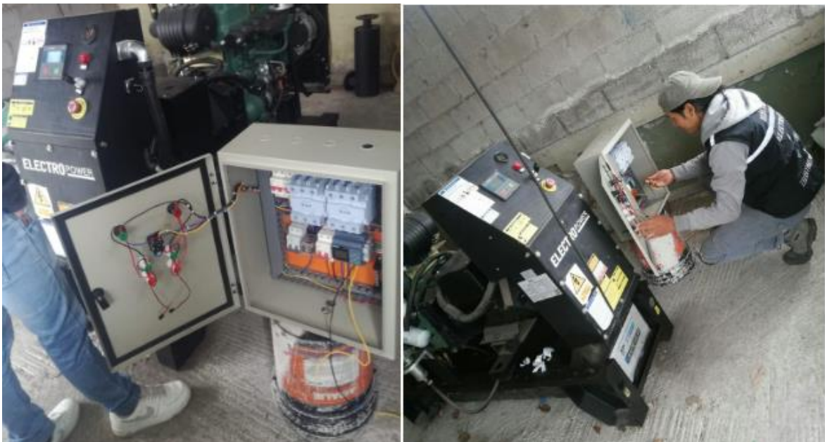
Anexo A.4. Pruebas de funcionamiento del Tablero de transferencia con el Generador AF22D6.
