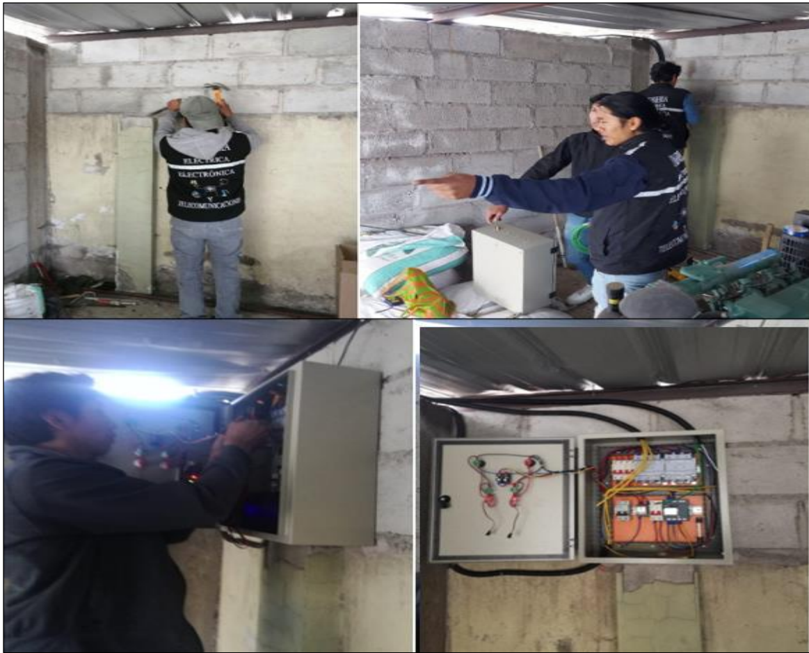
Anexo A.5. Instalación y empotrado del tablero de Sistema de Transferencia Automático.
