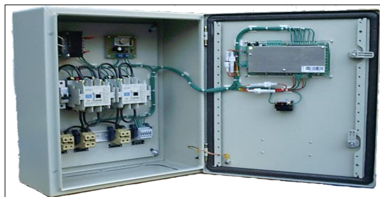
Figura 4: Tablero de Transferencia Eléctrica
