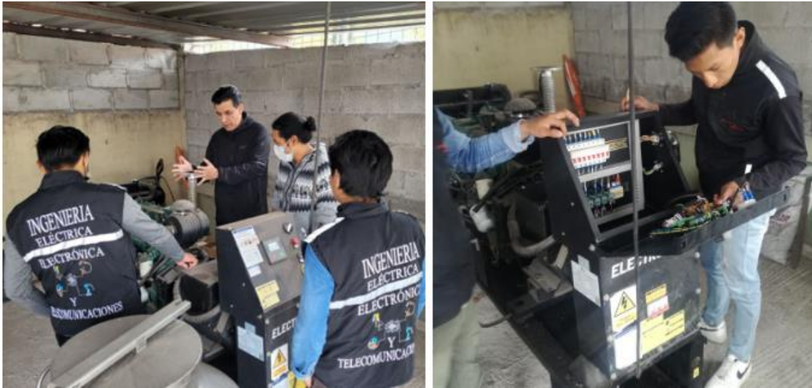
Anexo A.1. Visita técnica para revisión del Generador modelo AF22D6.
