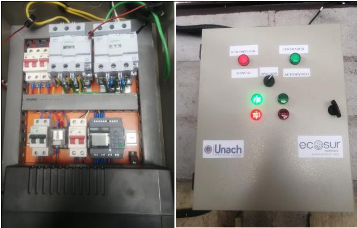
Anexo A.7. Tablero de Transferencia Automático terminado.
