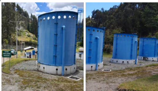
Figura 6. Filtros Percoladores Biológicos
