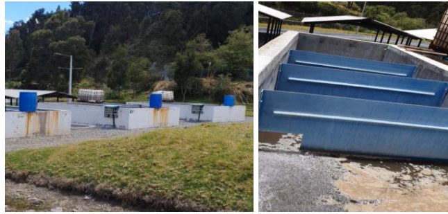
Figura 7. Tanques Sedimentadores con Ozonificadores
