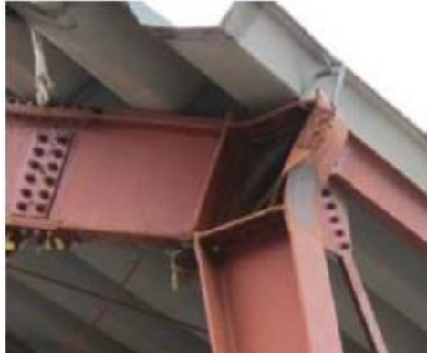
Ilustración 17: Deformación excesiva en la zona del panel.
